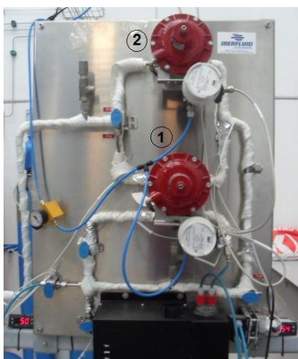
Figura B.30- Panel de reducción de presión de trabajo hasta presión atmosférica de la instalación de fase gas a presión.
