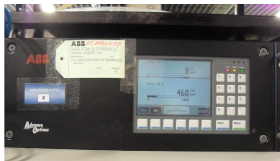
Figura B.35- Analizador CO/CO 2 .
