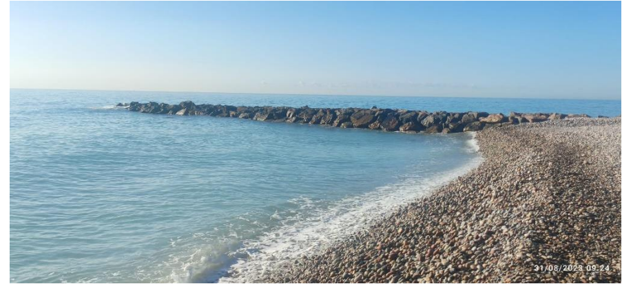
Ilustración 26. Espigón 5 (pendiente rehabilitación) 1
