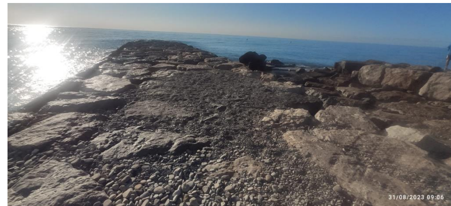
Ilustración 17. Espigón 3 (pendiente rehabilitación) 2
