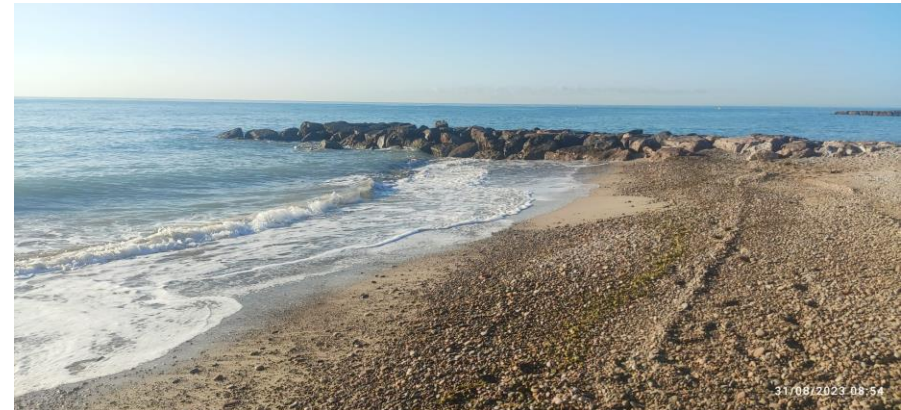
Ilustración 11. Espigón 1 (pendiente rehabilitación) 1
