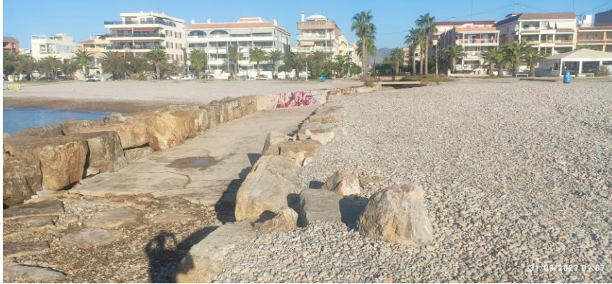
Ilustración 20. Espigón 3 (pendiente rehabilitación) 3
