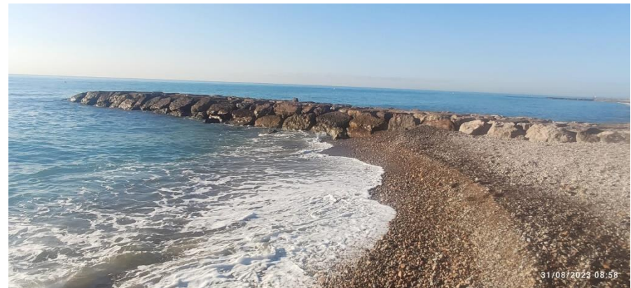
Ilustración 10. Espigón 1 (pendiente rehabilitación) 2
