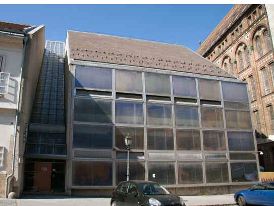
Fig. 3.19. Antes de su demolición, la fachada presentaba un deterioro visible.
