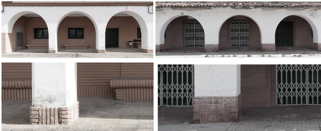
Aparejo de los zocalos de los pórticos del edificio de viajeros de Cariñena (izda) y Caminreal (dcha)
