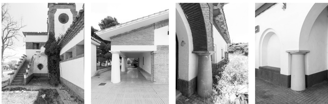
Detalles constructivos de los edificios de viajeros de Caminreal, María de Huerva, Encinacorba y Cariñena
