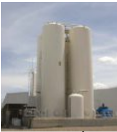
Figura 20: Área de tratamiento de lixiviados
