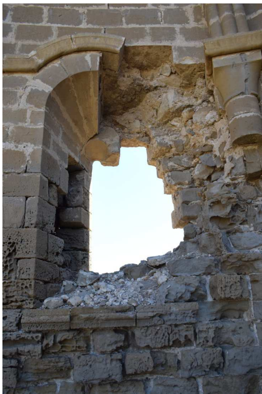
Figura 71. Vano abocinado de la cabecera. Su derrumbe permite apreciar claramente su estructura.
