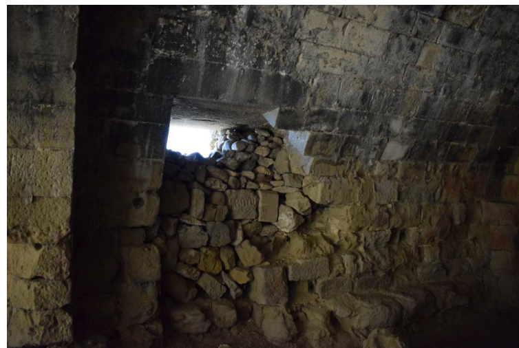
Figura 63. Muro sur de la iglesia inconclusa. Se aprecia un vano medio cegado por la acumulación de piedras.
