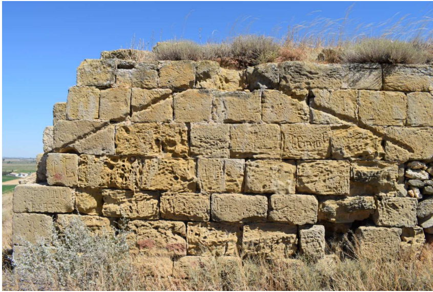
Figura 77. Exterior de la nave, iglesia inconclusa. Muro sur. Detalle de un triángulo labrado en los sillares, tal vez huella de una tejadillo anexo. Bajo él, marcas populares que reflejan el abandono del monumento y su alta exposición a actos vandálicos.
