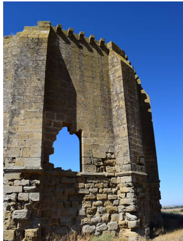
Figuras 74. Vano abocinado arruinado de la cabecera (exterior).
