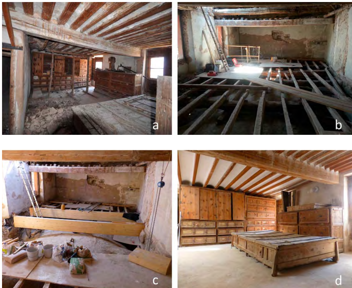
Figura 9. Antigua sala capitular. a) Estado inicial; b) Desmontaje del forjado sobre la bóveda de la sacristía; c) Realización del nuevo forjado; d) Estado final.
