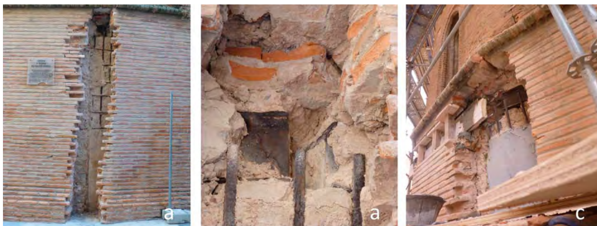
Figura 7. Ábside y sacristía. a) Cata en uno de los pilares del refuerzo instalado en 1969; b) Detalle del apoyo de los dinteles de acero, mostrando el estado de corrosión y la ausencia de empotramiento y continuidad de estos elementos; c) Proceso de saneado de un pilar y sustitución del encadenado.
