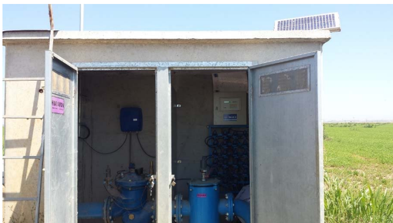
FOTOGRAFÍA 5. Hidrante en una de las parcelas del Sector XI del Flumen.
