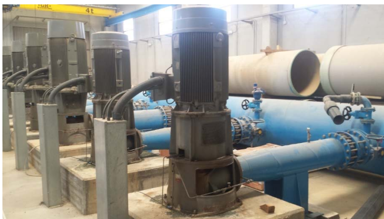
FOTOGRAFÍA 6. Estación de Bombeo 2.
