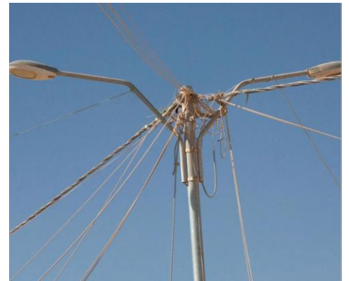
[Fig. 47] Conexiones privadas ilegales de los refugios a la red eléctrica común de Zaatari.
