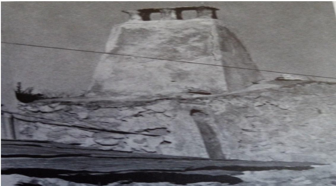
Chimenea de prisma cuadrangular de Crevillente (Alicante). Imagen: Luis Feduchi, Itinerarios de arquitectura española, 1976, p. 396
