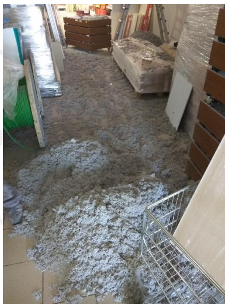
Imagen 8: desorden. Aislamiento acumulado en obra.
