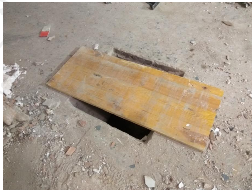
Imagen 2: hueco en forjado mal tapado
