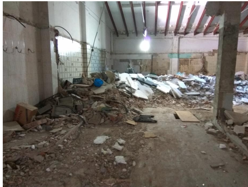
Imagen 1: acumulación de escombros en obra.
