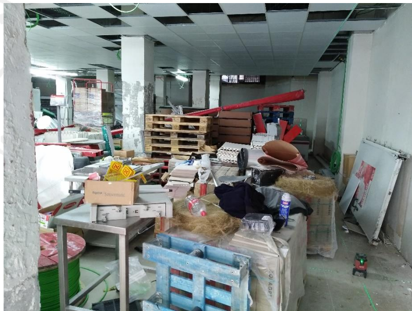
Imagen 10: desorden. Acumulación de material en obra.
