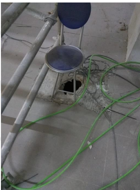
Imagen 4: hueco en forjado tapado con silla. Cables desordenados.
