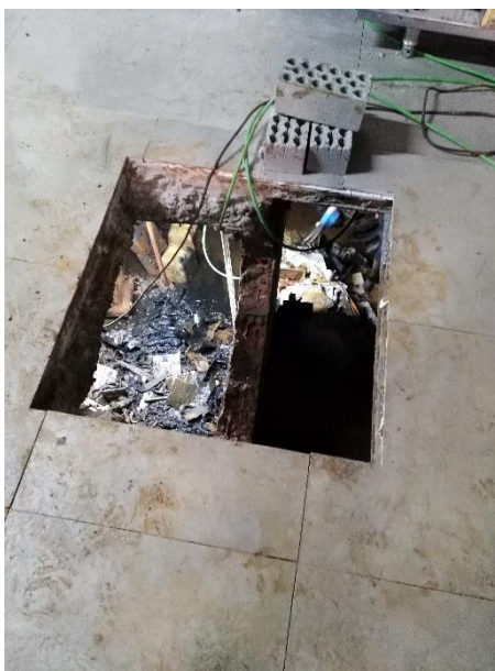
Imagen 3: acceso inadecuado a espacio confinado
