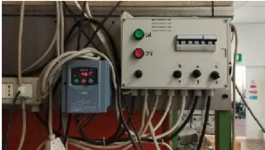
Figura 4.7 Pannello di controllo.
