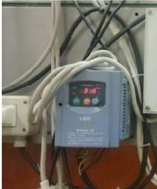
Figura 4.6 Inverter che regola il numero di giri.
