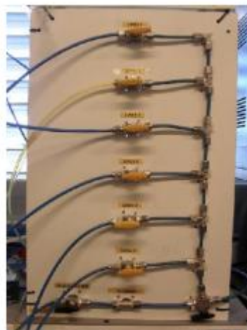
Figura 55. Panel de válvulas.
