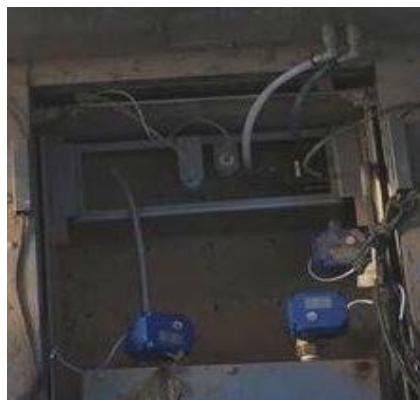
Figura 4. Depósito de muestreo con detalles instalado en campo.
