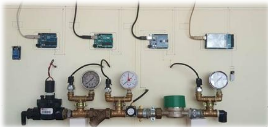
Figura 18. Sistema de monitorización y automatización.
