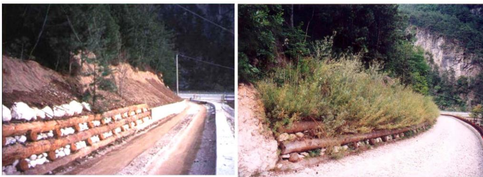
Figura 95: Estabilización en las obras de la vía férrea mantovana en Trieste (Udine) con entramado doble. Fuente: (Giuliano, S., 2008)
