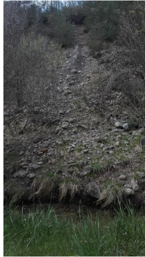
Figura 59: Talud en contacto con el Barranco de Fuentesviñas. Fuente: Elaboración propia
