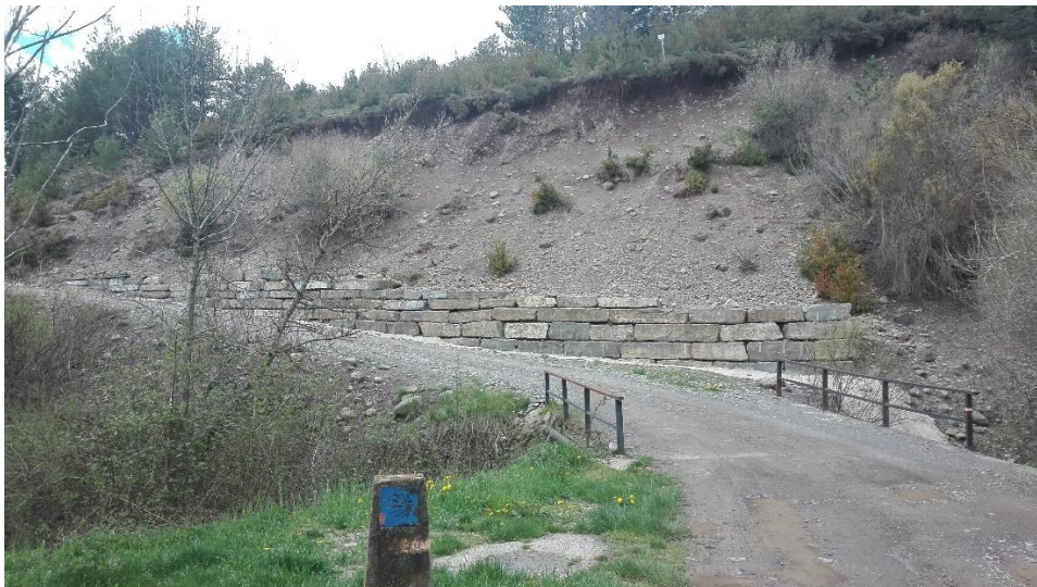
Figura 2: Talud del caso práctico. Fuente: Elaboración propia
