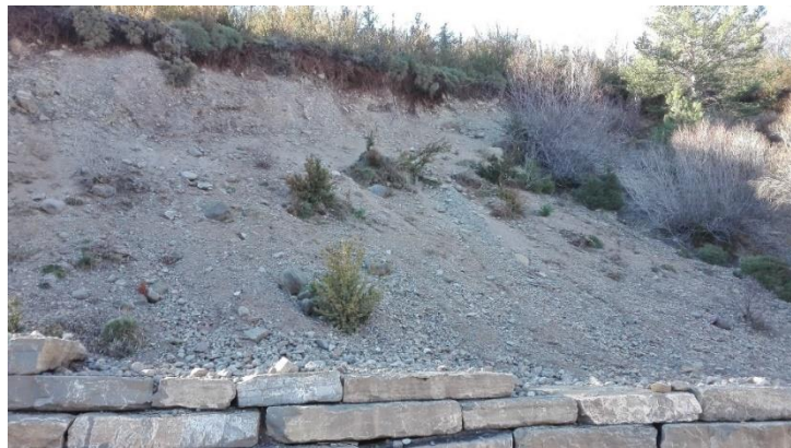
Figura 46: Vegetación observada dentro del talud en la prospección del 9 de enero de 2019. Fuente: Elaboración propia
