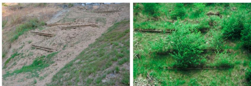
Figura 93: Estabilización de un talud sobre el túnel Olandixo (Arrasate) con empalizada viva. Fuente: (Sangalli, P., 2012)
