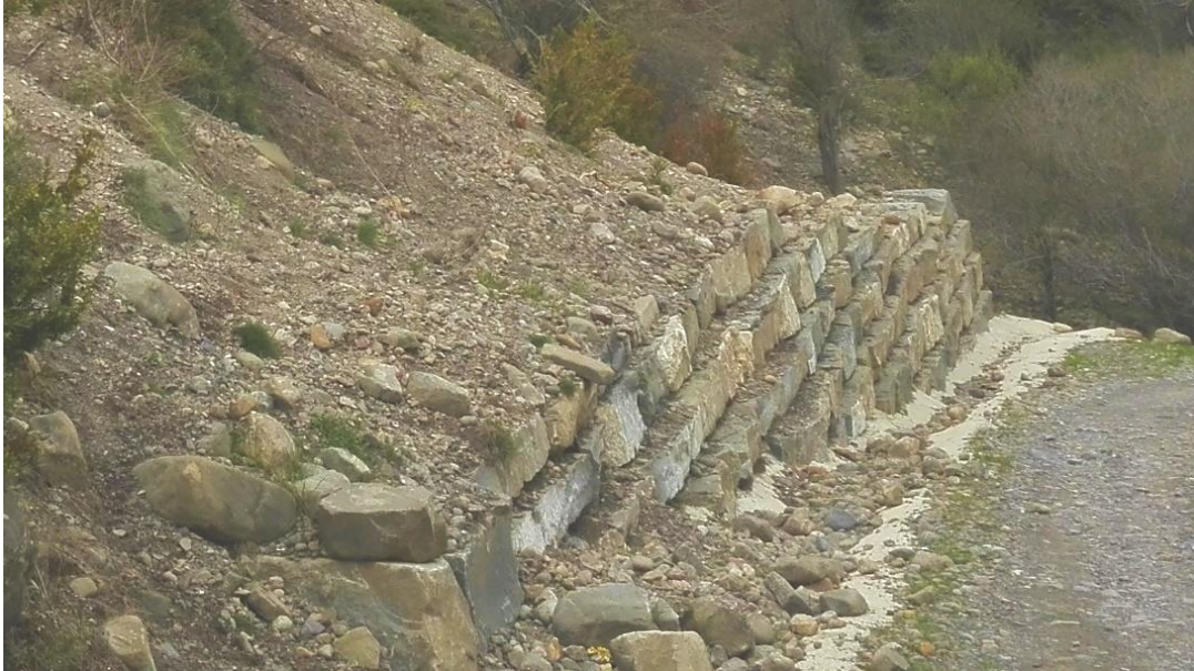
Figura 73: Acumulación de tierra en el trasdós de la escollera. Fuente: Elaboración propia.
