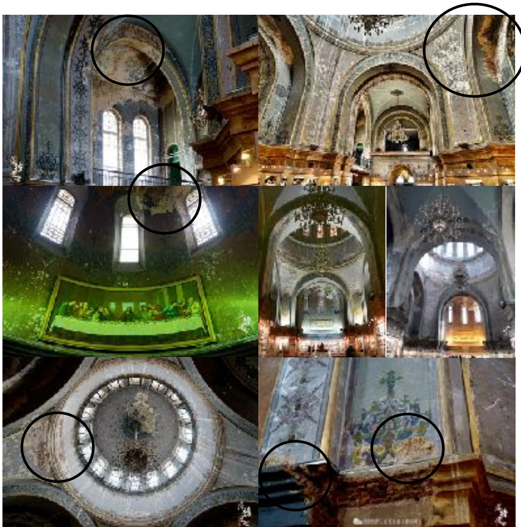
Pared muy separada y dañada
