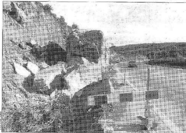
Las débiles rocas han provocado el desprendimiento de un gran bloque en la N330 al paso por el Puerto de Monrepós.
