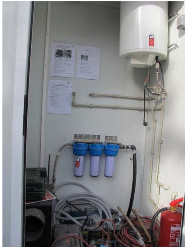
Ilustración 3 calentador y sistema de tratamiento de agua, interior del cuarto técnico
