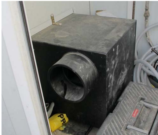
Ilustración 5 aspirador filtro de alta eficacia, interior del cuarto técnico
