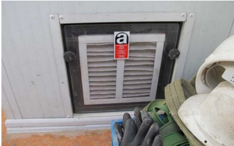
Ilustración 4 rejilla del aspirador de alta eficacia, interior del cuarto sucio
