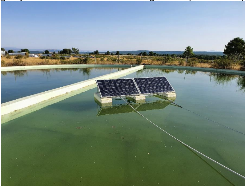
Figura 20, paneles fotovoltaicos flotantes en el depósito del CEDER
