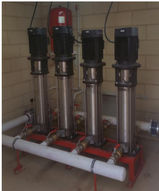
Figura 26, tenemos sistema de bombeo con 4 bombas de 7,5 kw cada una
