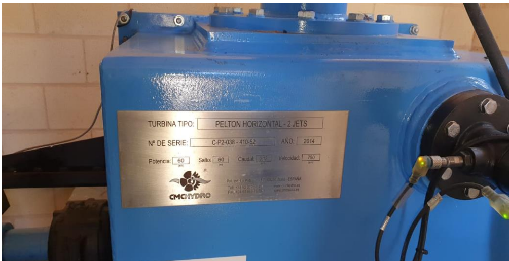
Figura 9, Placa características de la turbina
