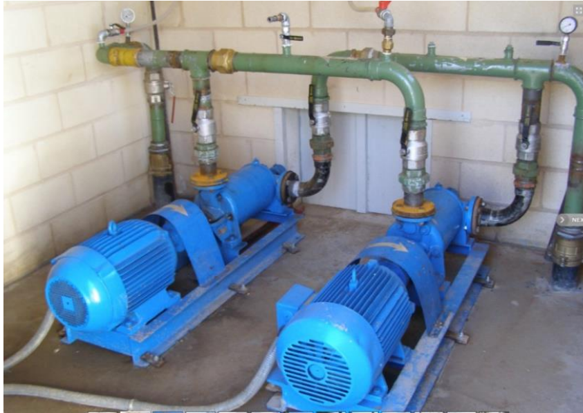
Figura 25, sistema de bombeo con dos bombas de 23 kw cada una
