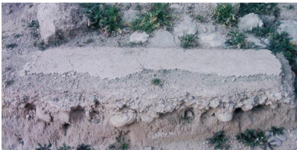
Imagen de uno de los dos pavimentos in situ hallados en el área localizada entre calle Coso, n° 37 y Plaza de España (Fuente: M a José Arbués)
