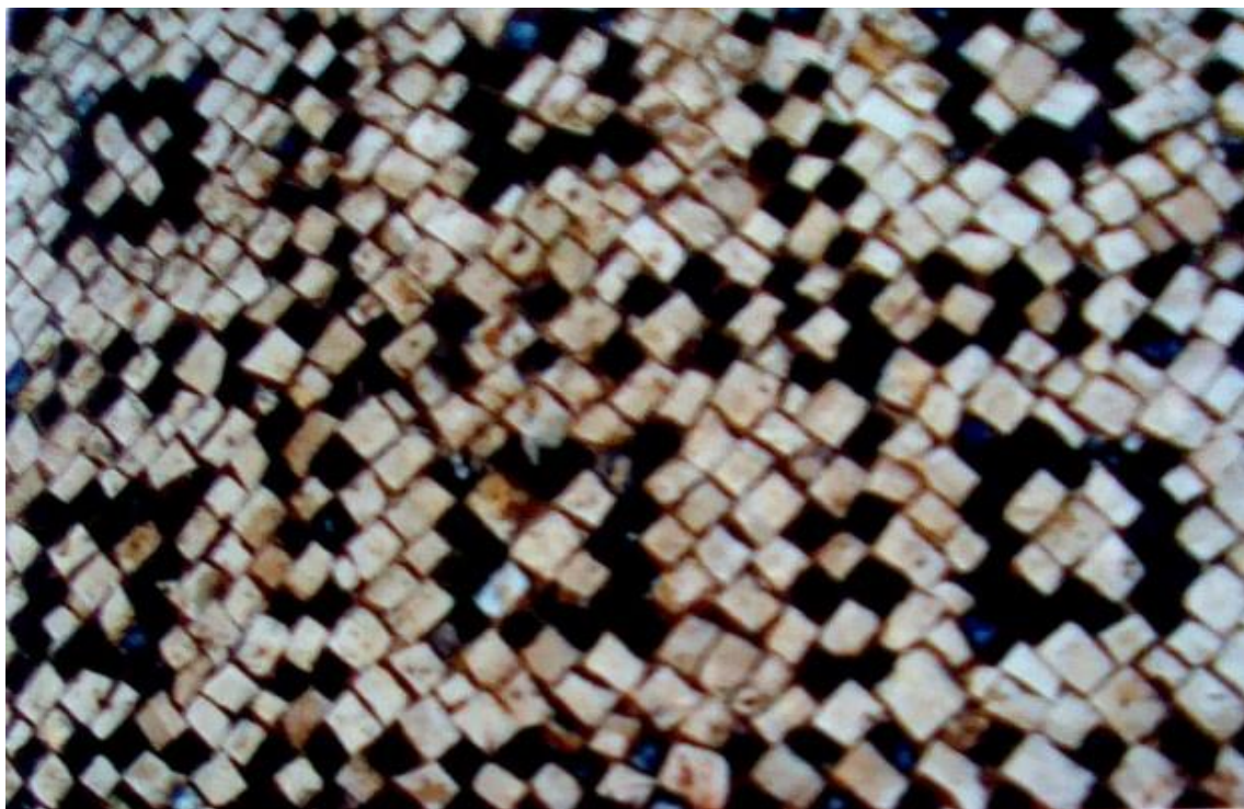
Fotografías de dealle del pavimento (Fuente: AACAA, Expdte. Expdte.086/03/04)
