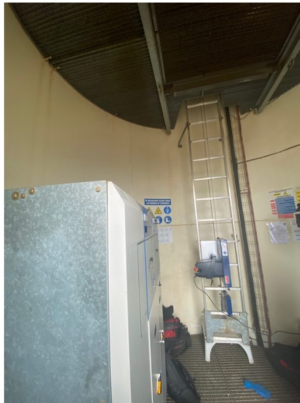
Ilustración 8. Vista interior aerogenerador
