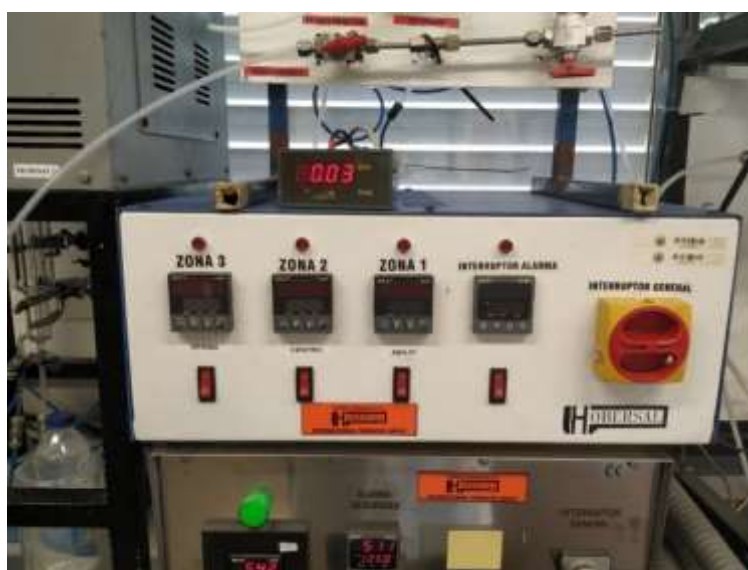
Figura 7. Sistema de control de temperaturas del horno eléctrico.
