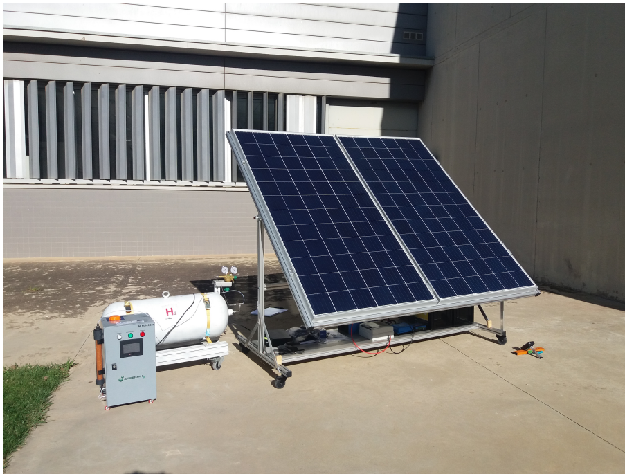
Figura 2.1: Sistema híbrido de generación eléctrica empleado durante el proyecto.
