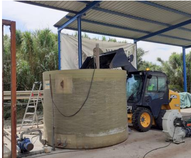
Ilustración 10. Adición de fango deshidratado al depósito de carga
