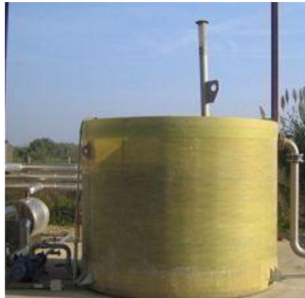
Ilustración 5. Tanque de alimentación.
