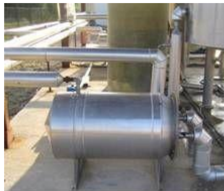
Ilustración 4. Intercambiador de calor agua fango
