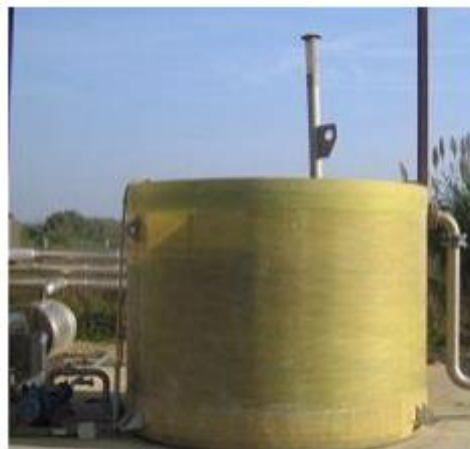
Ilustración 5.-Tanque de alimentación
