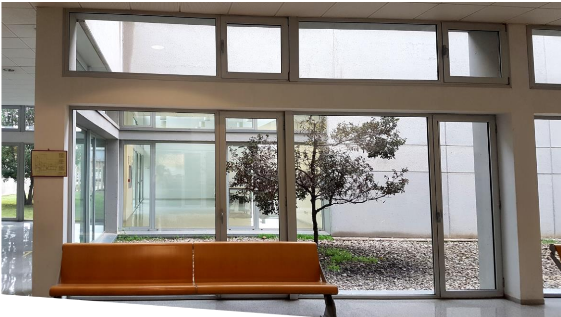
Ilustración 69: Puente térmico vigas y pilares de hormigón armado sin aislar y encuentro con carpintería. Fuente: Elaboración propia
