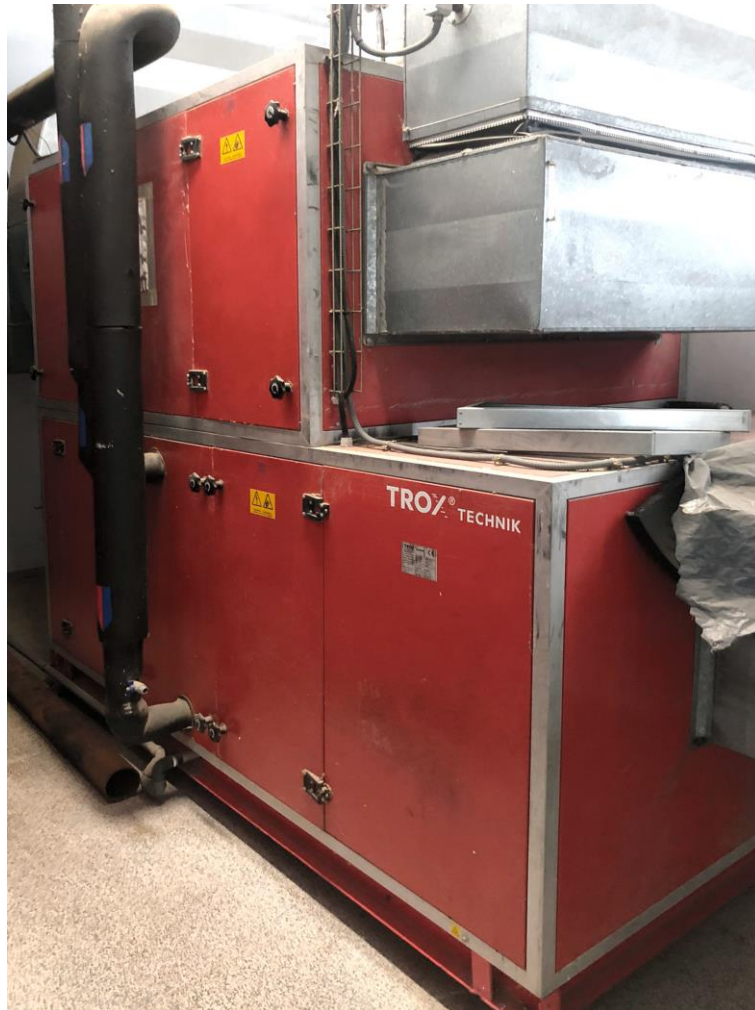
Ilustración 89: Climatizador de la Sala de estudios. Fuente: Elaboración propia
