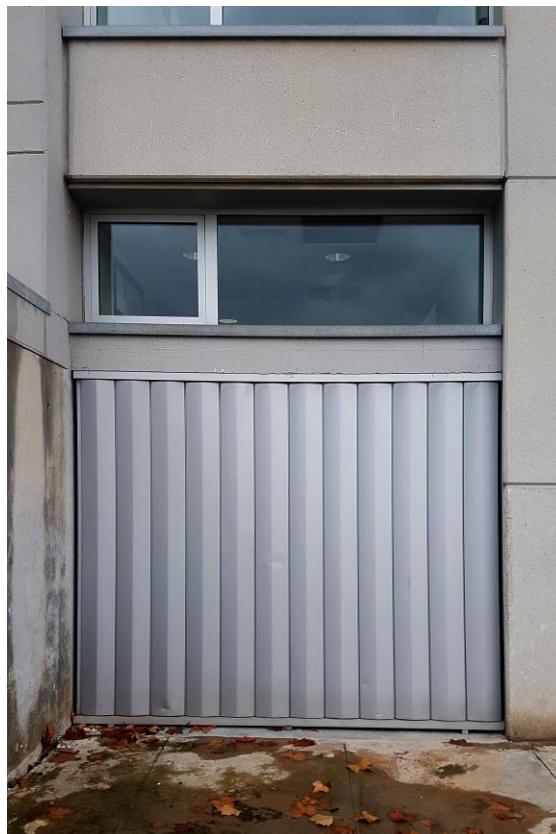
Ilustración 67: Puente térmico por viga sin aislar. Fuente: Elaboración propia
