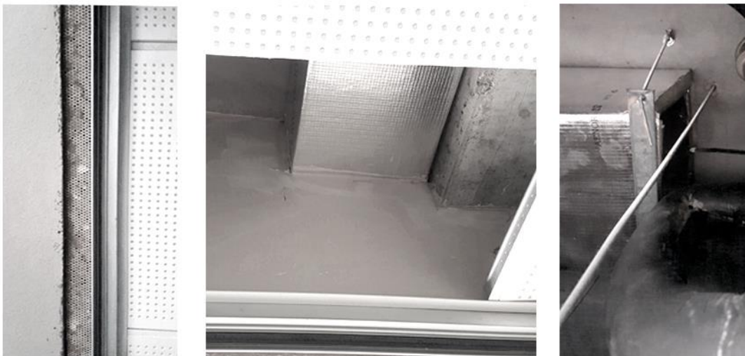
Ilustración 91: Partes del tubo de toma de aire exterior de un aula. Fuente: elaboración propia
