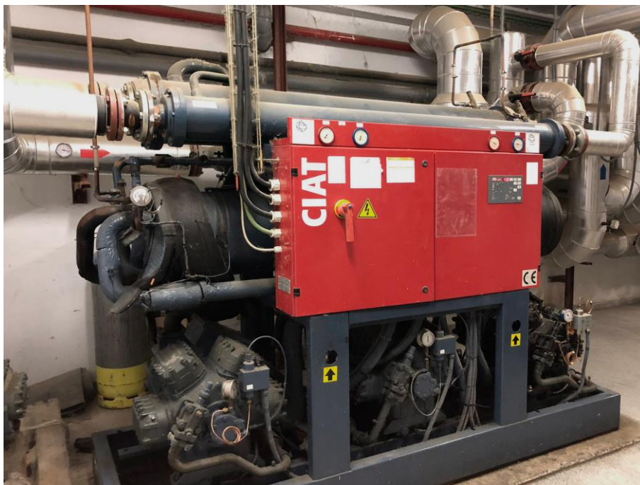
Ilustración 85:Bomba de calor del edificio Lorenzo Normante. Fuente: elaboración propia
