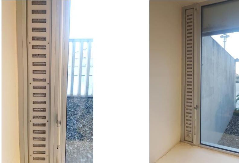
Ilustración 84: Puente térmicos producido por los aireadores. Fuente: Elaboración propia
