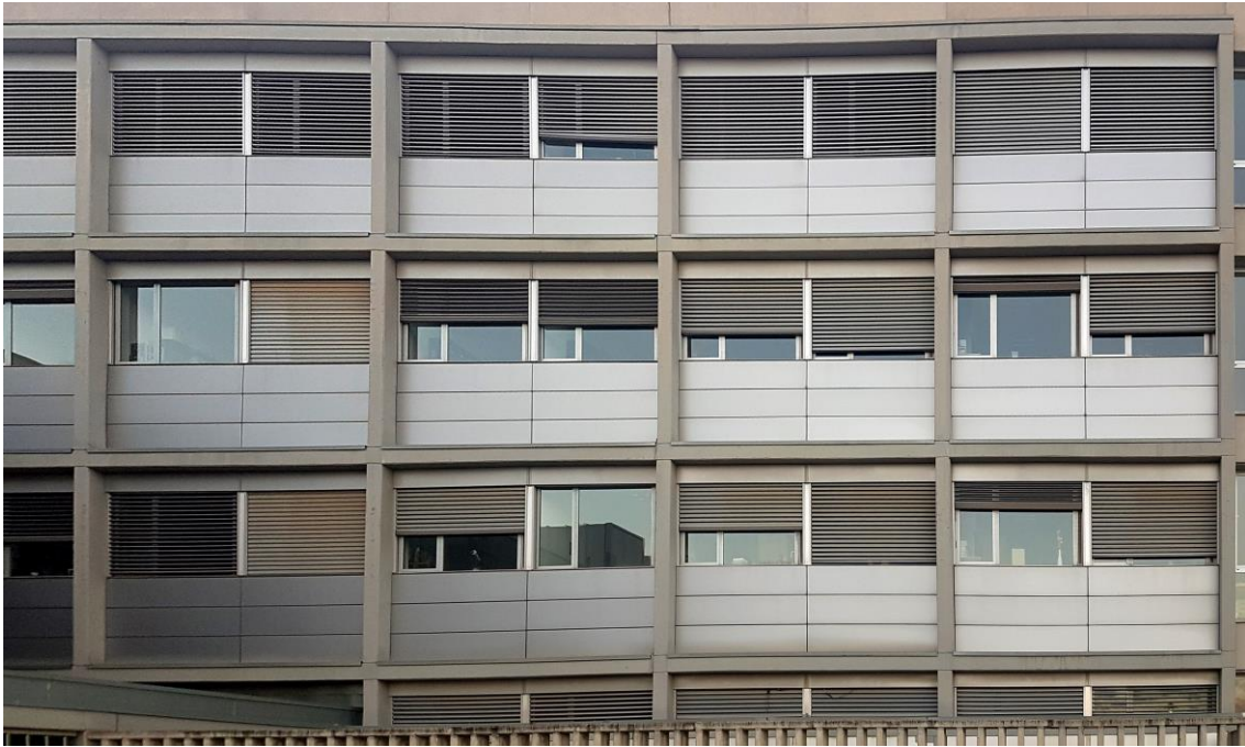
Ilustración 68: Puente térmico forjados y pilares sin aislar. Fuente: Elaboración propia
