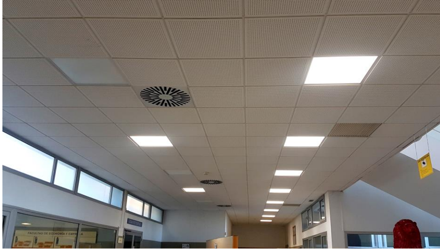
Ilustración 90: Imagen de rejillas de toma y retorno a fan-coil de techo en el pasillo de la planta baja. Fuente: Elaboración propia.
