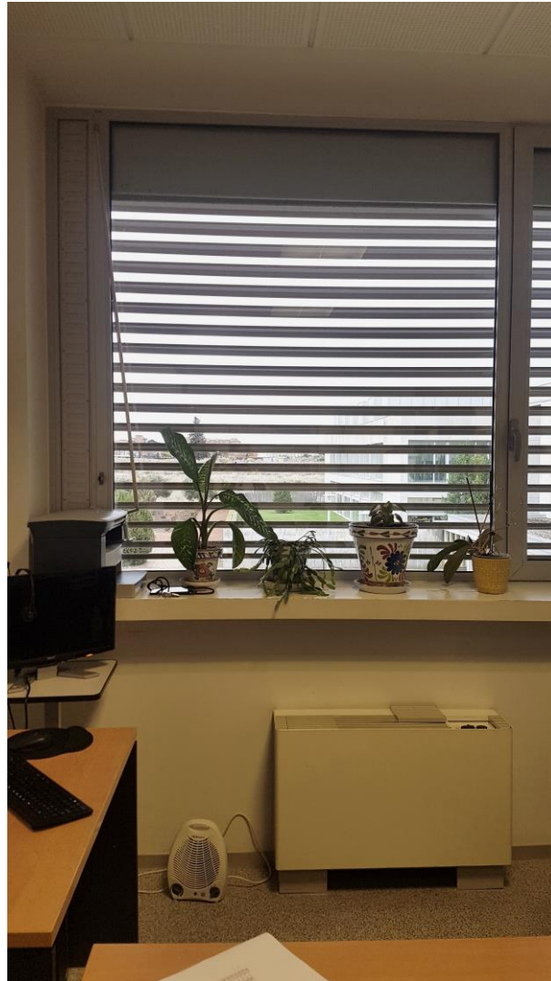
Ilustración 92: Imagen fan-coil y ventana con aireador de un despacho. Fuente: Elaboración propia
