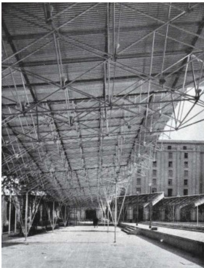
Fig. 161. Detalle de la estructura del pabellón ya levantado y cubierto. Fuente: Revista Arquitectura , n. 66, junio 1964.
