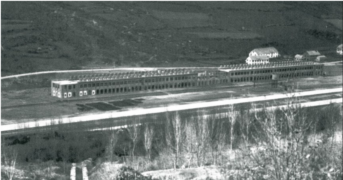
Fig. 132. Estructura del Edificio de Servicio en otoño de 1923. Se puede observar que muchos elementos, como los ventanales de la planta de mansardas, se prefabricaban en cemento con molde y eran colocados en obra para acortar los tiempos de construcción. Imagen extraída de Canfranc: El Mito, p. 287.
