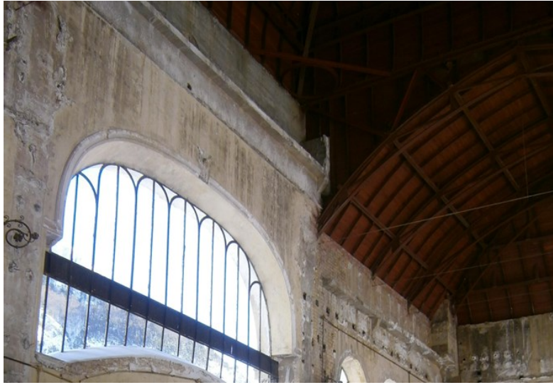
Fig. 192. Jácena perimetral de hormigón armado en el vestíbulo, que sirve de contrapeso a la cornisa exterior, no prevista en los planos originales. También se aprecian los machones de hormigón en los rincones que soportaban los pináculos. Foto del autor.
