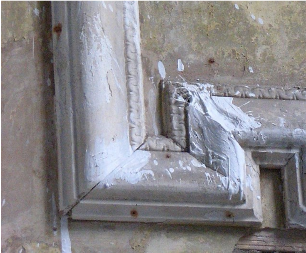
Fig. 314. Restos de molduras deterioradas en la zona del vestíbulo en 2014. Foto del autor.
