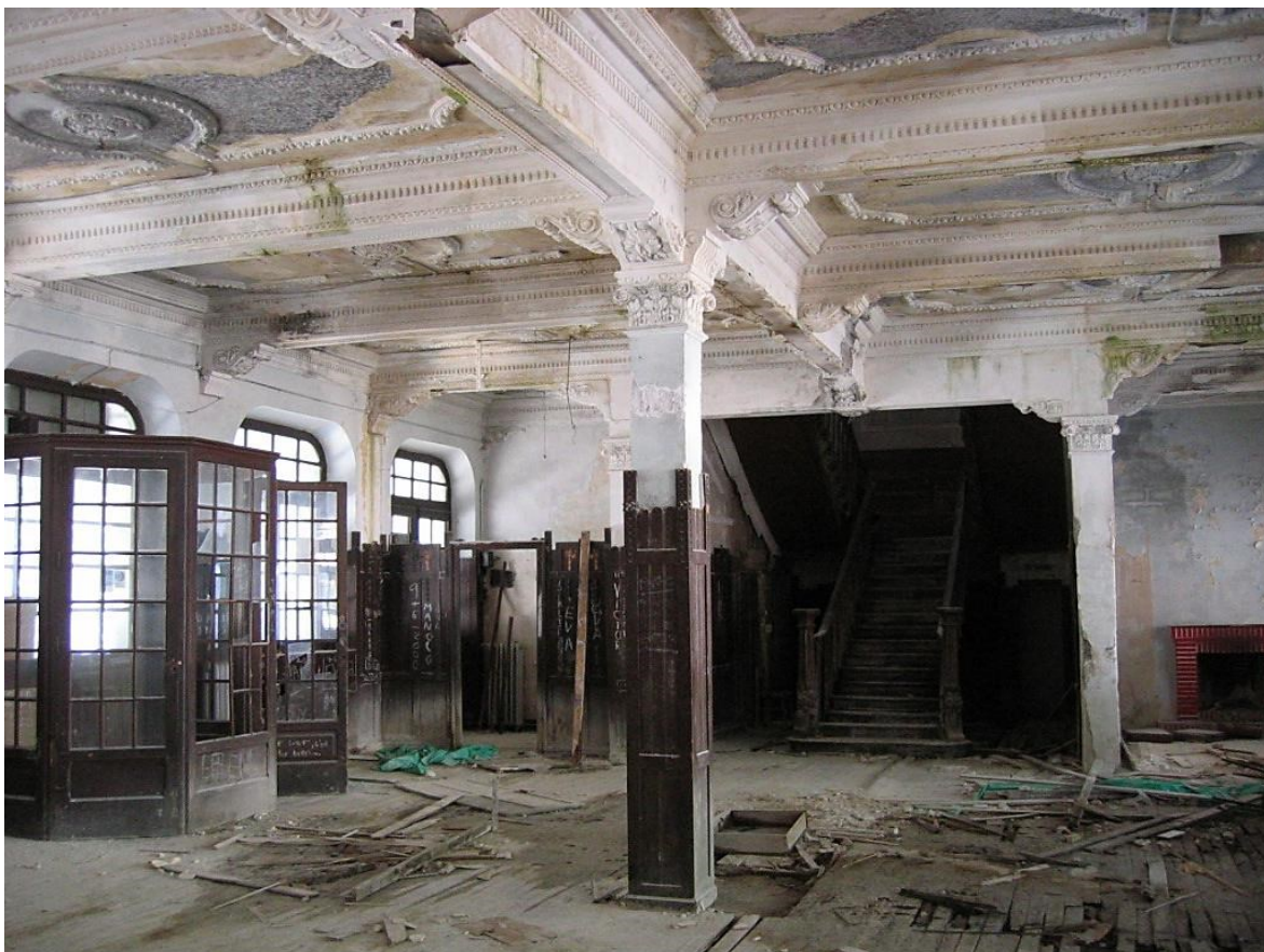
Fig. 251. Zona del restaurante en estado de ruina. Foto: David Ibáñez. Toda la decoración interior, incluida la de la imagen, lamentablemente desapareció tras la intervención de rehabilitación que comenzó en 2006.
