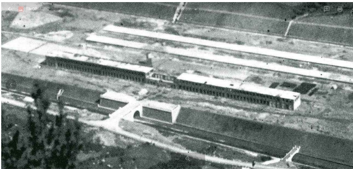
Fig. 131. Construcción del Edificio de Servicio hasta la altura de la primera planta. Imagen extraída de Canfranc. El Mito, p. 283.
