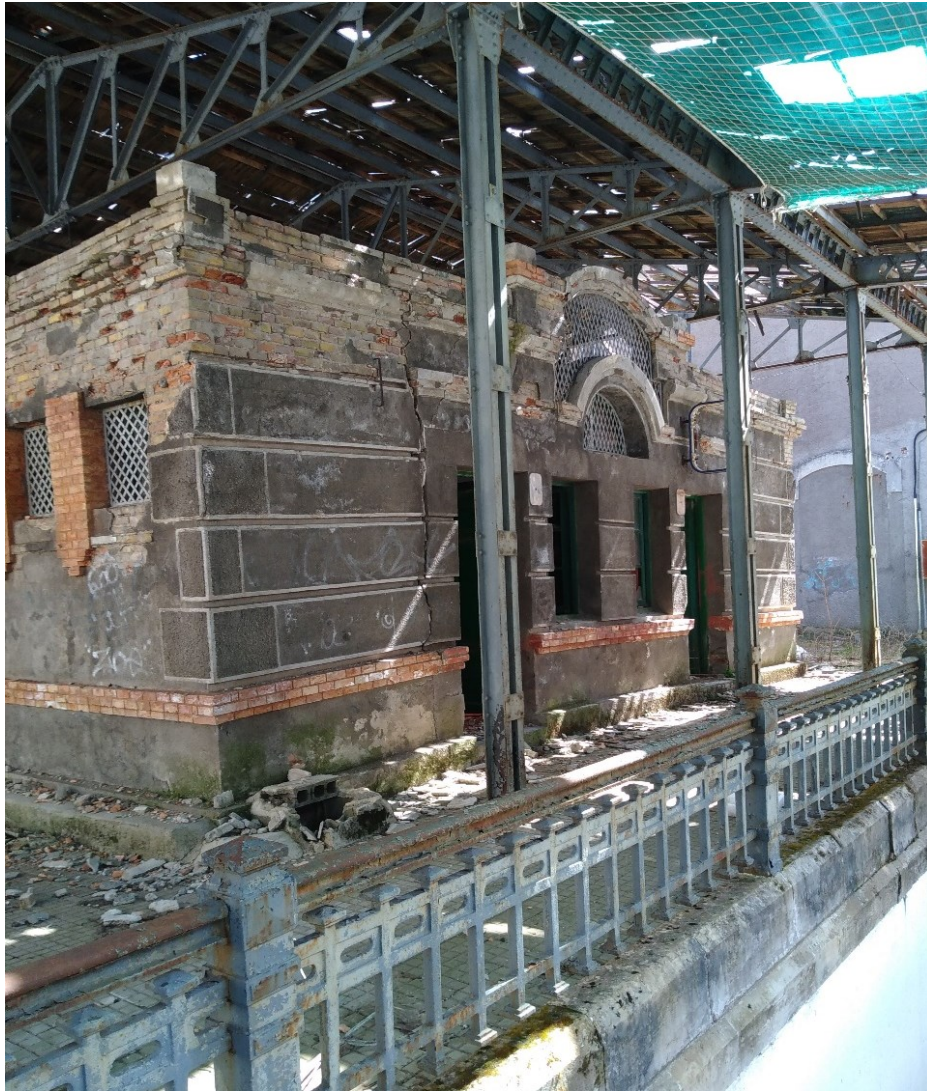
Fig. 176. Edificio para aseos al sur del Edificio de Servicio poco antes de su derribo durante las actuaciones de 2020. Desde que fue construido sufrió graves deterioros por asentamiento del terreno al no estar ubicado sobre los cimientos. Foto: Belén Domínguez.
