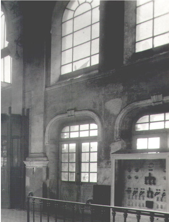
Figs: 246 y 247. En estos dos detalles extraídos de la fotografía anterior, se aprecian los daños producidos por el incendio de 1931 en el vestíbulo. En la imagen de la izquierda, restos de humo y deconchados en el lienzo este.
