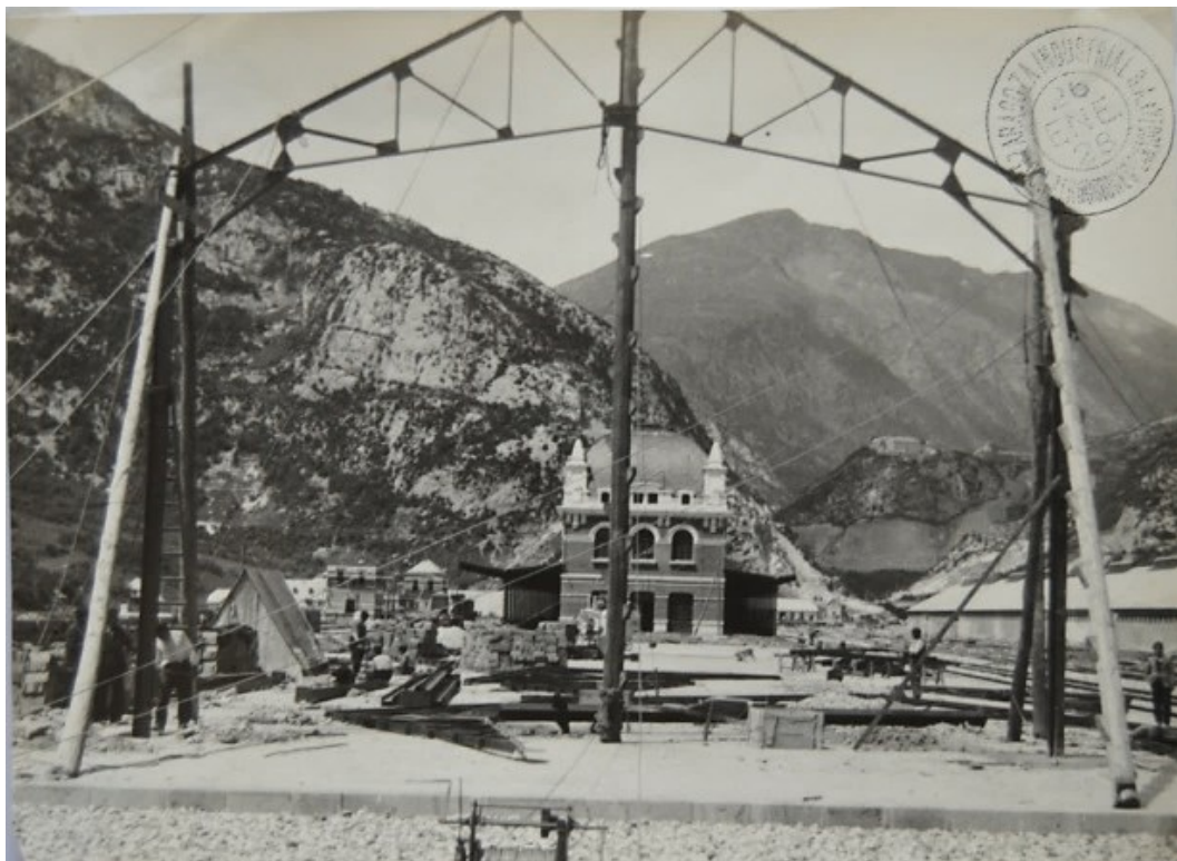
Fig. 167. Obras de construcción del Pabellón postal por la empresa Zaragoza Industrial S.A. Aunque el sello está fechado en enero de 1928, la imagen está tomada en verano-otoño de 1927. Foto: Colección Alonso Robisco.
