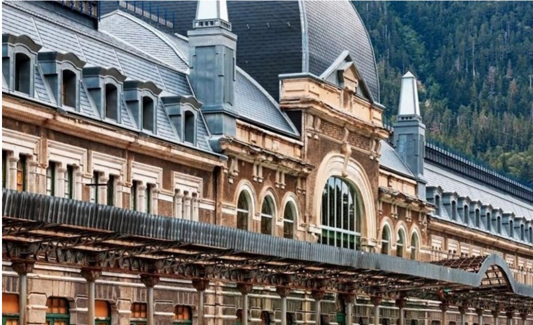
Fig. 191. Aspecto exterior de la fachada con la cornisa perimetral de hormigón armado de la zona del vestíbulo justo debajo de la cubierta. Foto del autor.
