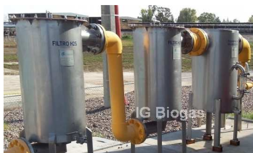
Figura 25 Filtros de Biogás
