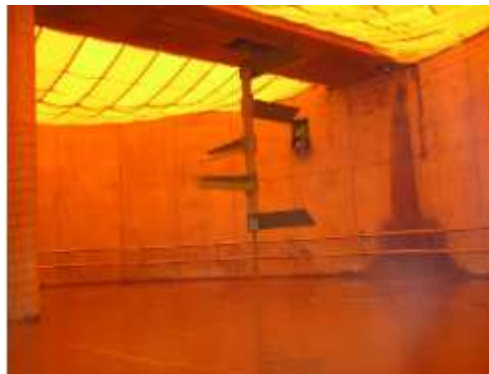
Figura 15 Interior de un digestor
