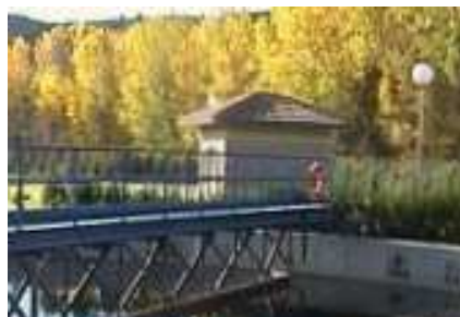
Figura 9 Cámara de cloración
