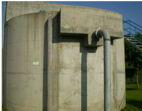
Figura 6 Depósito de fangos
