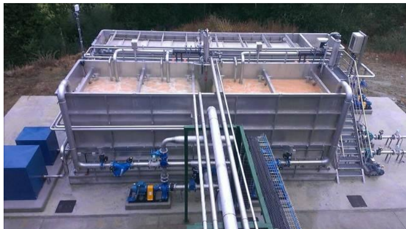
Figura 29. Instalación de un MBR en depósito de acero inoxidable. (Blog del agua)
