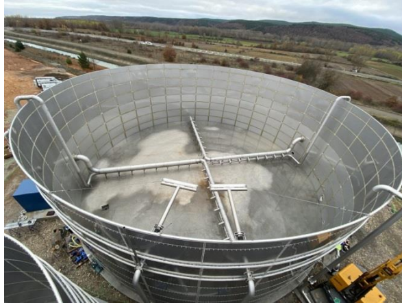
Figura 18. Homogeneizador con sistema de aireación/mezclado. (Aguas industriales)
