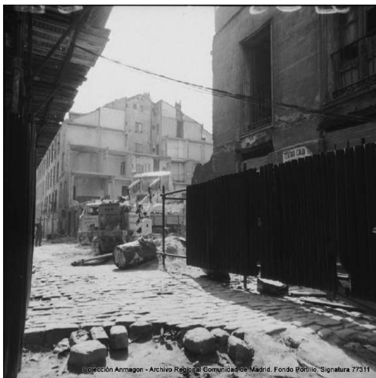
FIGURA 3B. VISTA DE LA CALLE DE HERMOSA, EN EL BARRIO DE LAS POZAS, MADRID, DURANTE EL PROCESO DE DERRIBO DE LAS VIVIENDAS, OCTUBRE 1969. Imagen: Colección Anmagón, Archivo Regional de la Comunidad de Madrid, Fondo Portillo, signatura 77311-023.
