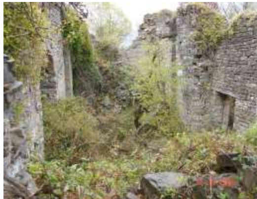
Fig. 24. Luque Herrán, Belén (12/10/2005) Interior de la nave hacia el ábside en ruinas de San Miguel de Yosa
