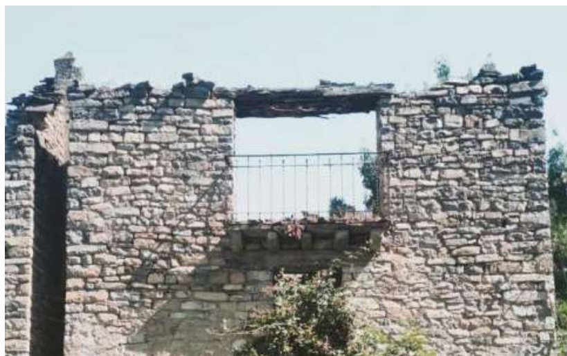
Fig. 42 y 43. Jarauta Félix, Jesús (2021) Ruinas de un balcón en Bescós y reconstrucción gráfica. Fotografía y elaboración propia. Trabajo de Fin de Grado. Escuela de Ingeniería y Arquitectura / Universidad de Zaragoza
