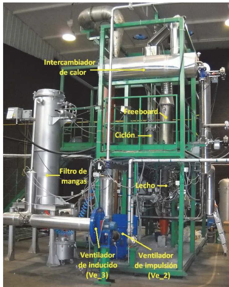
Figura A1. 4. Fotografía de la planta de oxidación de CIRCE.
