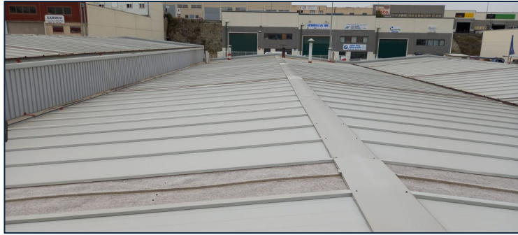
Imagen 14. Cubierta que albergará los módulos fotovoltaicos
