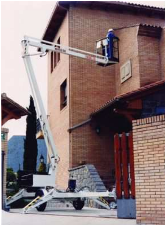
Figura 13. PEMP estabilizadores hidráulicos.
