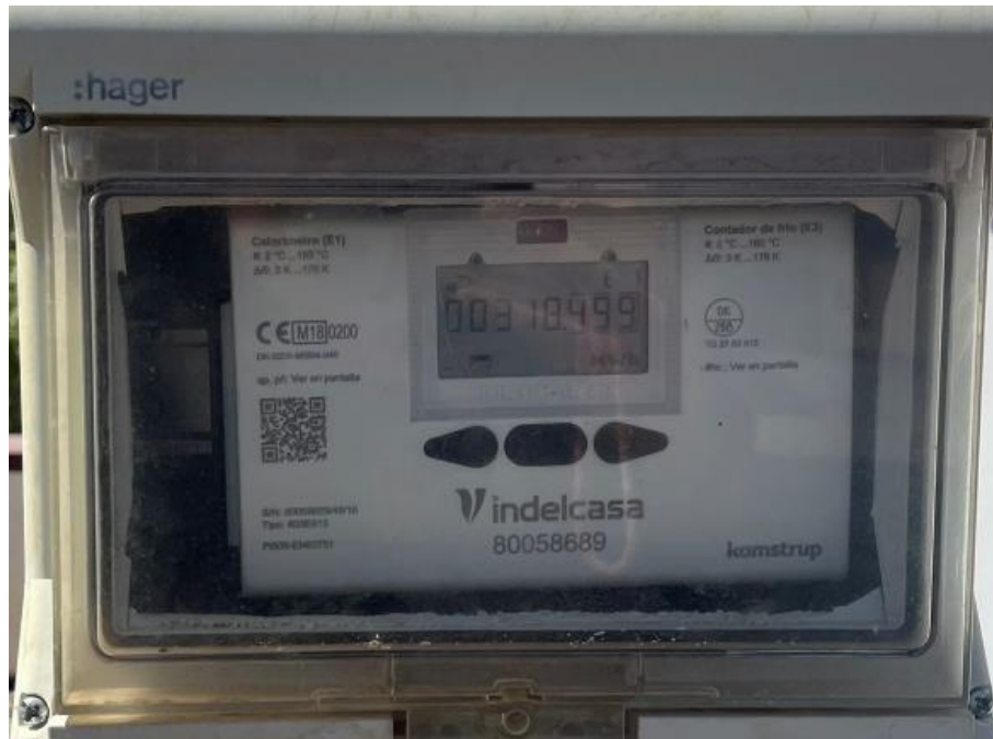
Ilustración 31 Contador sistema de climatización. Fuente: EP.
