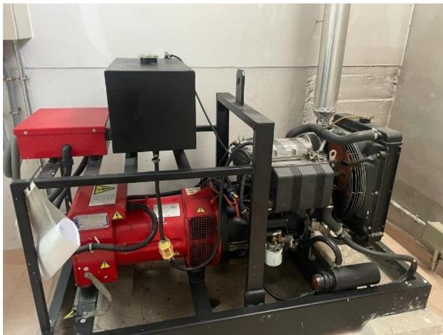
Ilustración 24 Grupo electrógeno. Fuente: EP.
