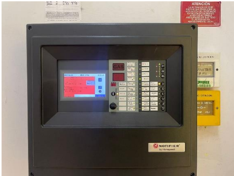
Ilustración 26 Central de alarma en el cuarto del grupo. Fuente: EP.
