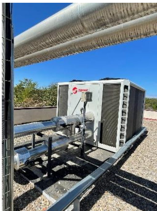
Ilustración 30 Sistema de climatización del edificio. Fuente: EP.
