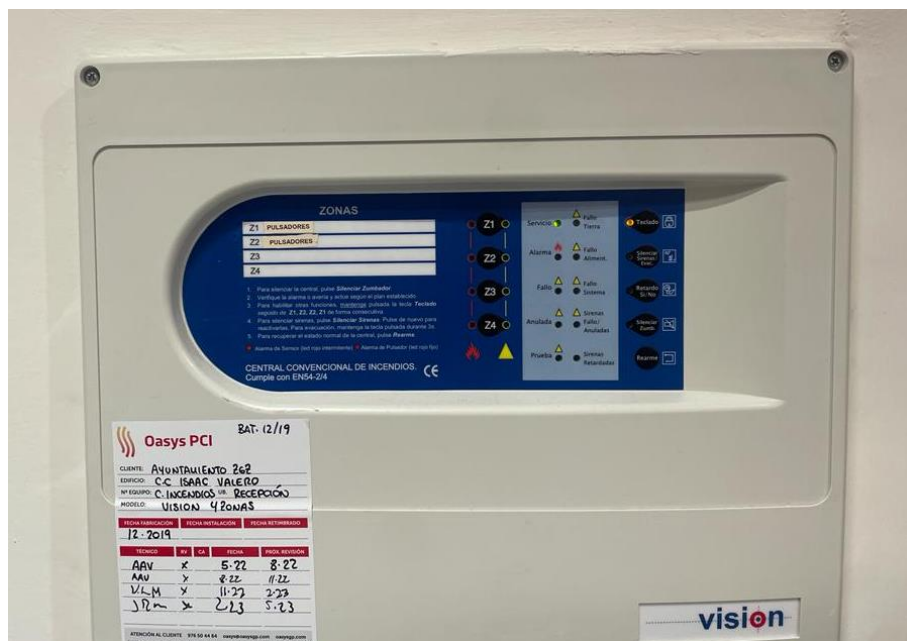
Ilustración 27 Central de alarma del Centro de Control. Fuente: EP.
