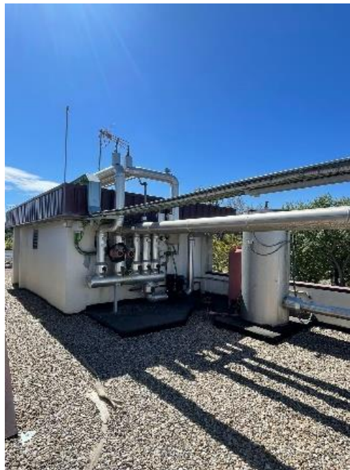
Ilustración 32 Bombas sistema de climatización. Fuente: EP.
