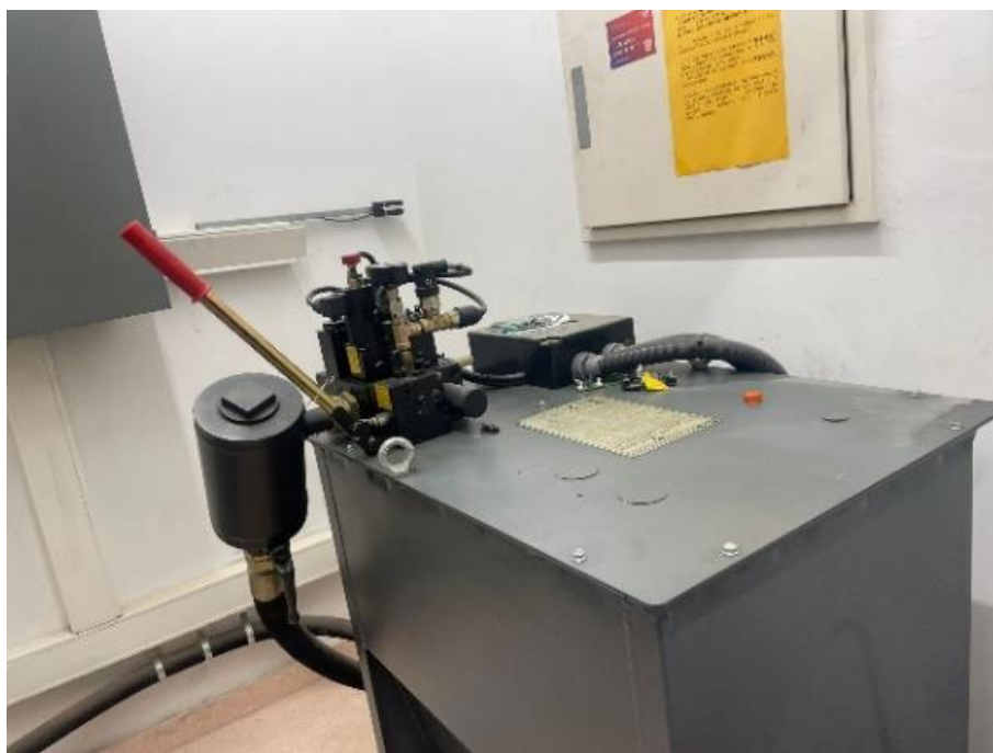
Ilustración 19 Sistema hidráulico del ascensor. Fuente: EP.
