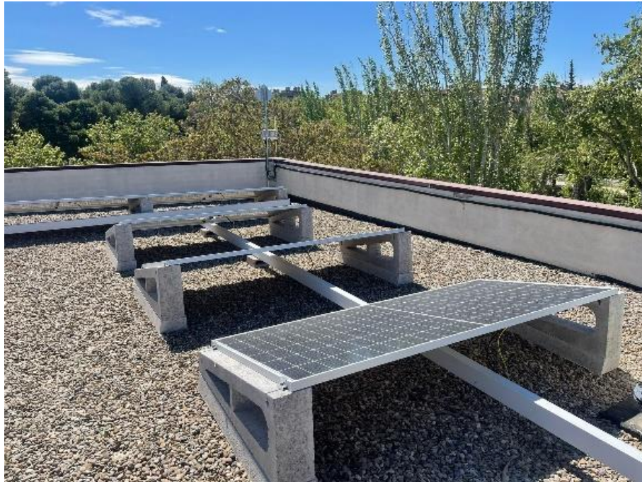
Ilustración 35 Placas solares. Fuente: EP.
