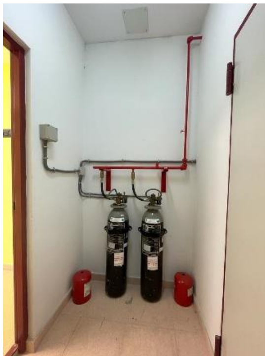
Ilustración 22 Botellas CO 2 sistema de extinción. Fuente: EP.
