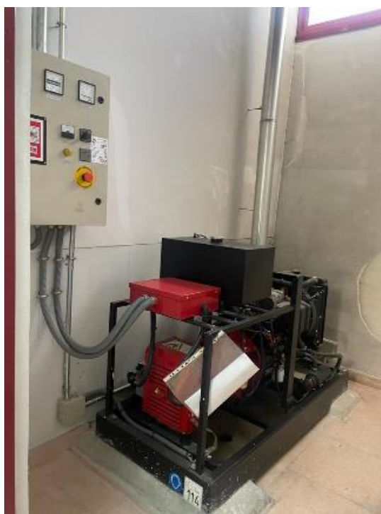
Ilustración 23 Grupo electrógeno. Fuente: EP.
