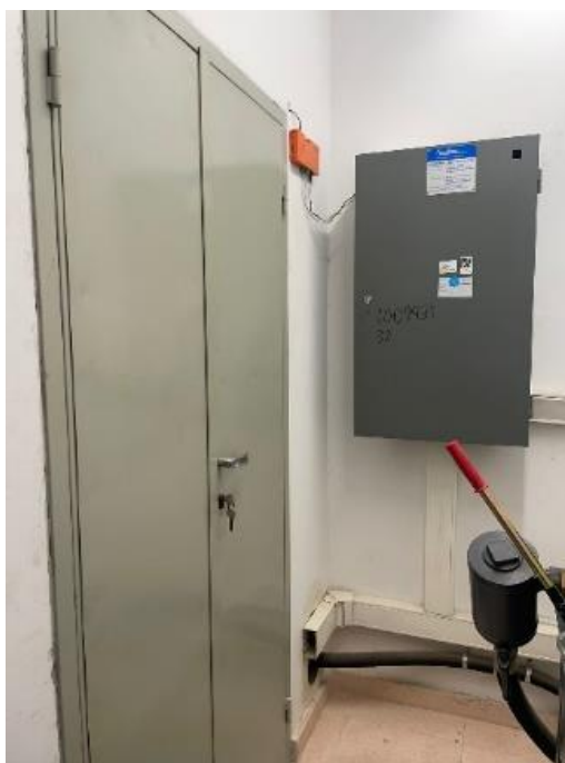
Ilustración 18 Cuarto del ascensor. Fuente: EP.
