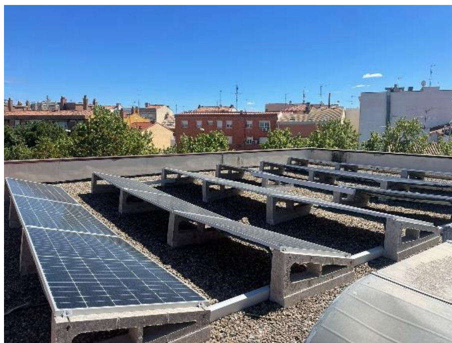
Ilustración 34 Placas solares. Fuente: EP.
