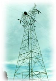
Figura 7. Foco sobre torre eléctrica
