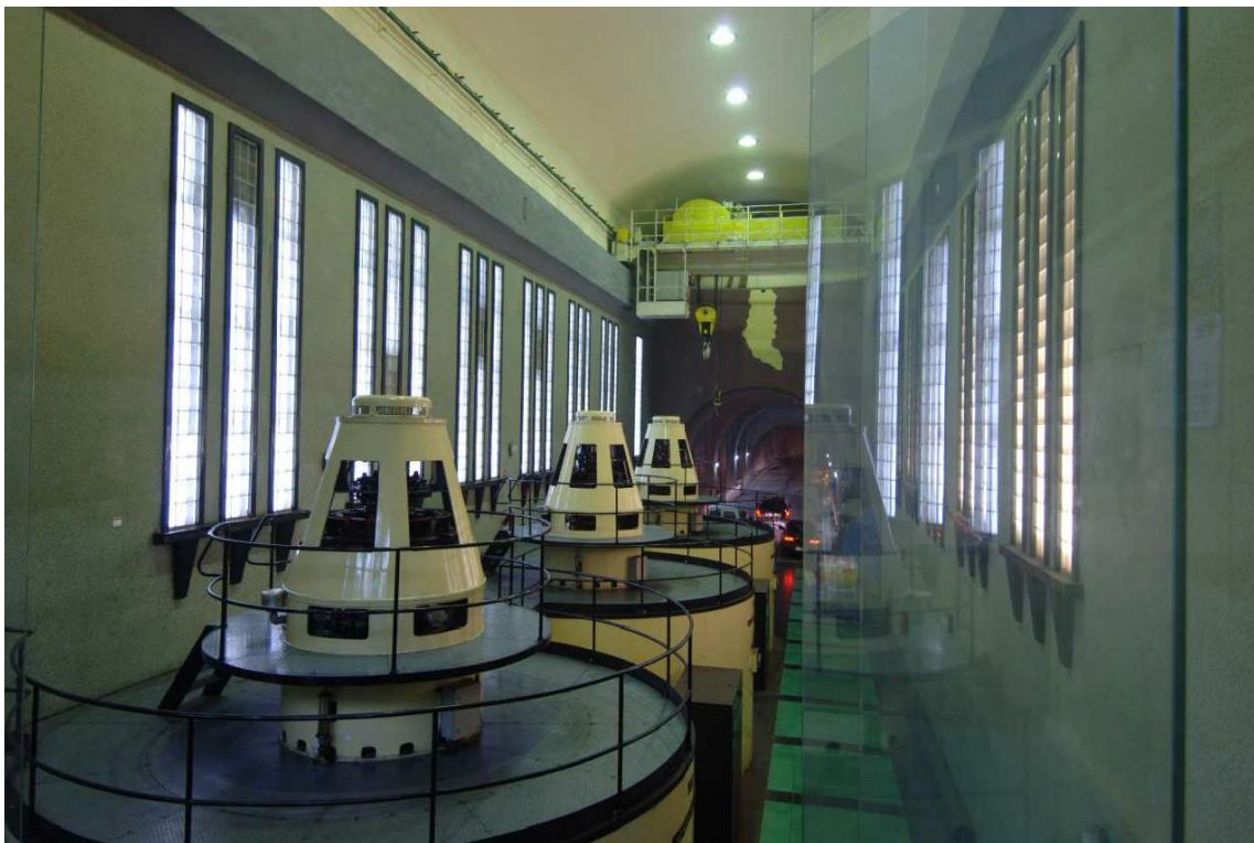
Interior de la Central Subterránea. Extraído de J.M. Buil, Op.Cit. pp. 23.
