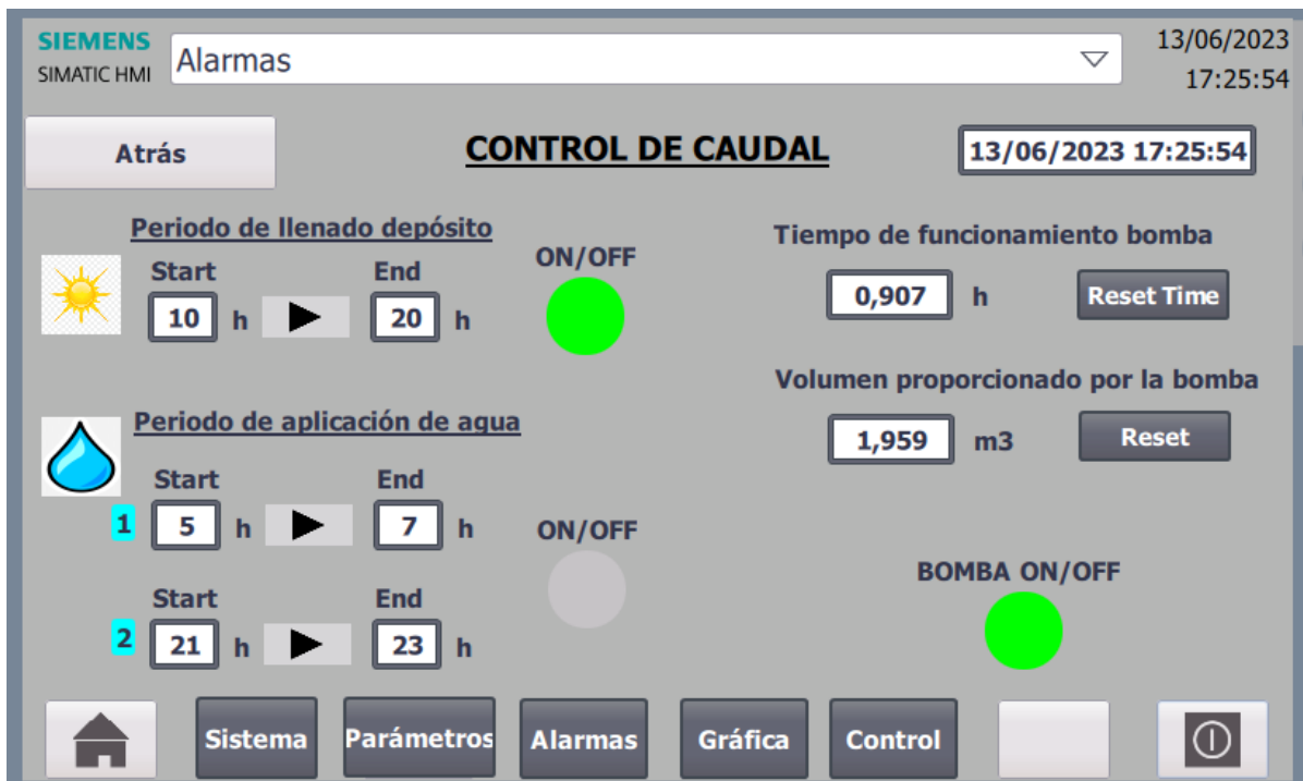
Figura 6-11. Control del caudal de la bomba HMI Nº1.
