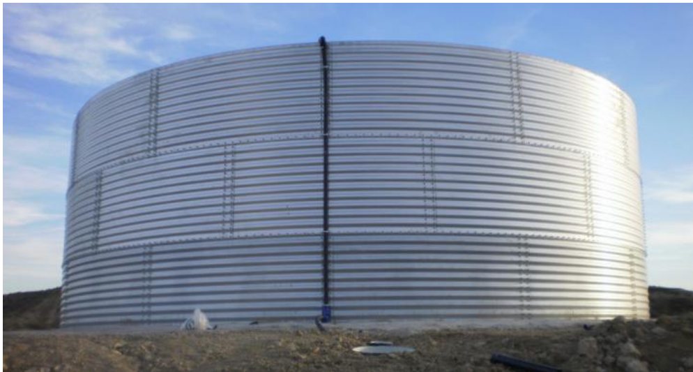
Figura 4-2. Depósito de agua de chapa, 90 m 3 (Bestagar, 2022).
