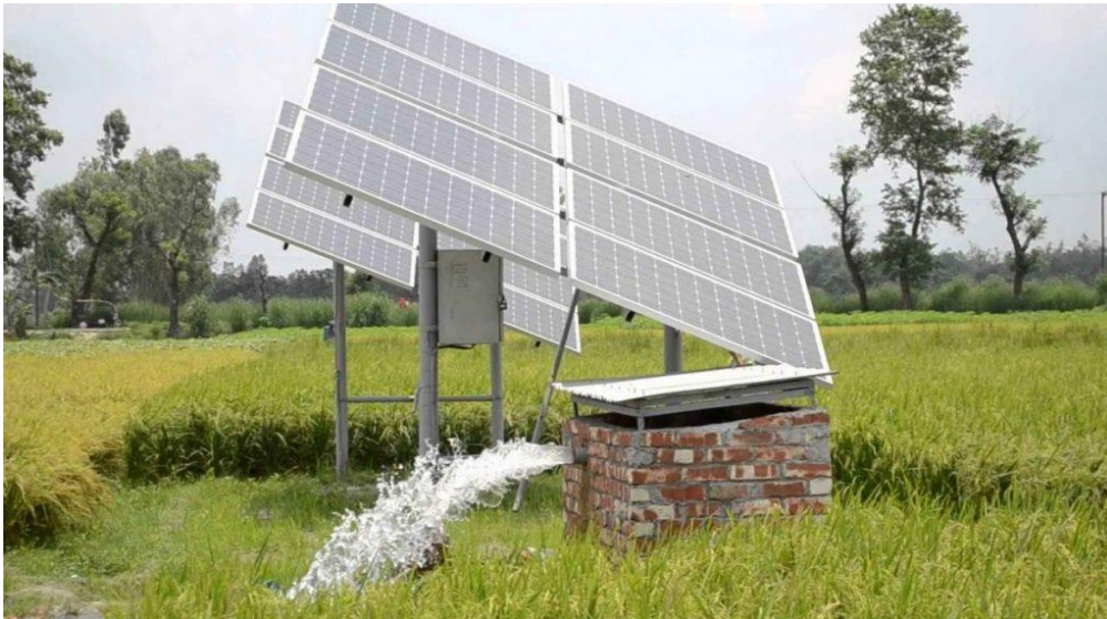
Figura 1-2. Instalación fotovoltaica con paneles policristalinos para bombeo de SolarPlak (SolarPlak, 2018).
