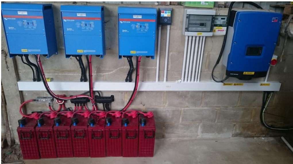
Figura 1-18. Almacenamiento en baterías de una instalación de paneles solares (SolarPlak, 2018).
