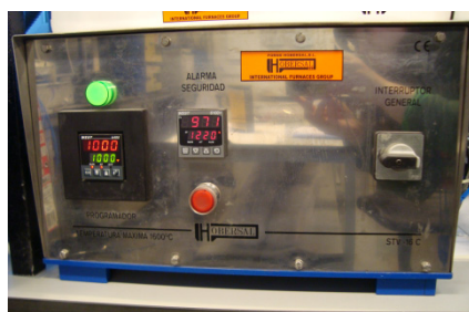
Figura 3.26. Controlador de temperatura.
