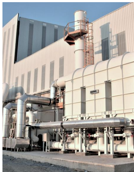
Ilustración 4: Depurador de gases
