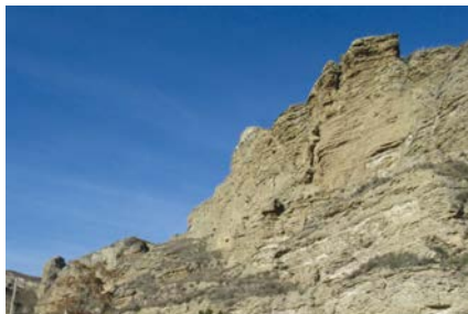
Escarpe al N de Calatayud donde pueden identificarse distintas inestabilidades gravitacionales afectando a niveles de yesos, margas y calizas.
