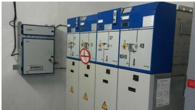
Endesa instalará 381 nuevos interruptores para intervenir de manera remota en líneas en caso de avería. / ENDESA
