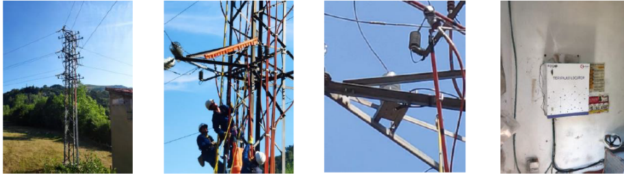
Figura 2.14: Instalación del TDR
