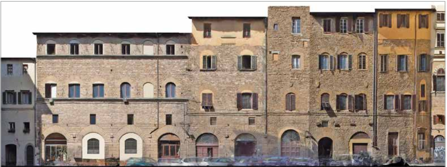
FIG. 124. Ortofoto del alzado sur de Piazza Peruzzi de la zona de la ciudad de Florencia que conserva el trazado del antiguo anfiteatro romano.
