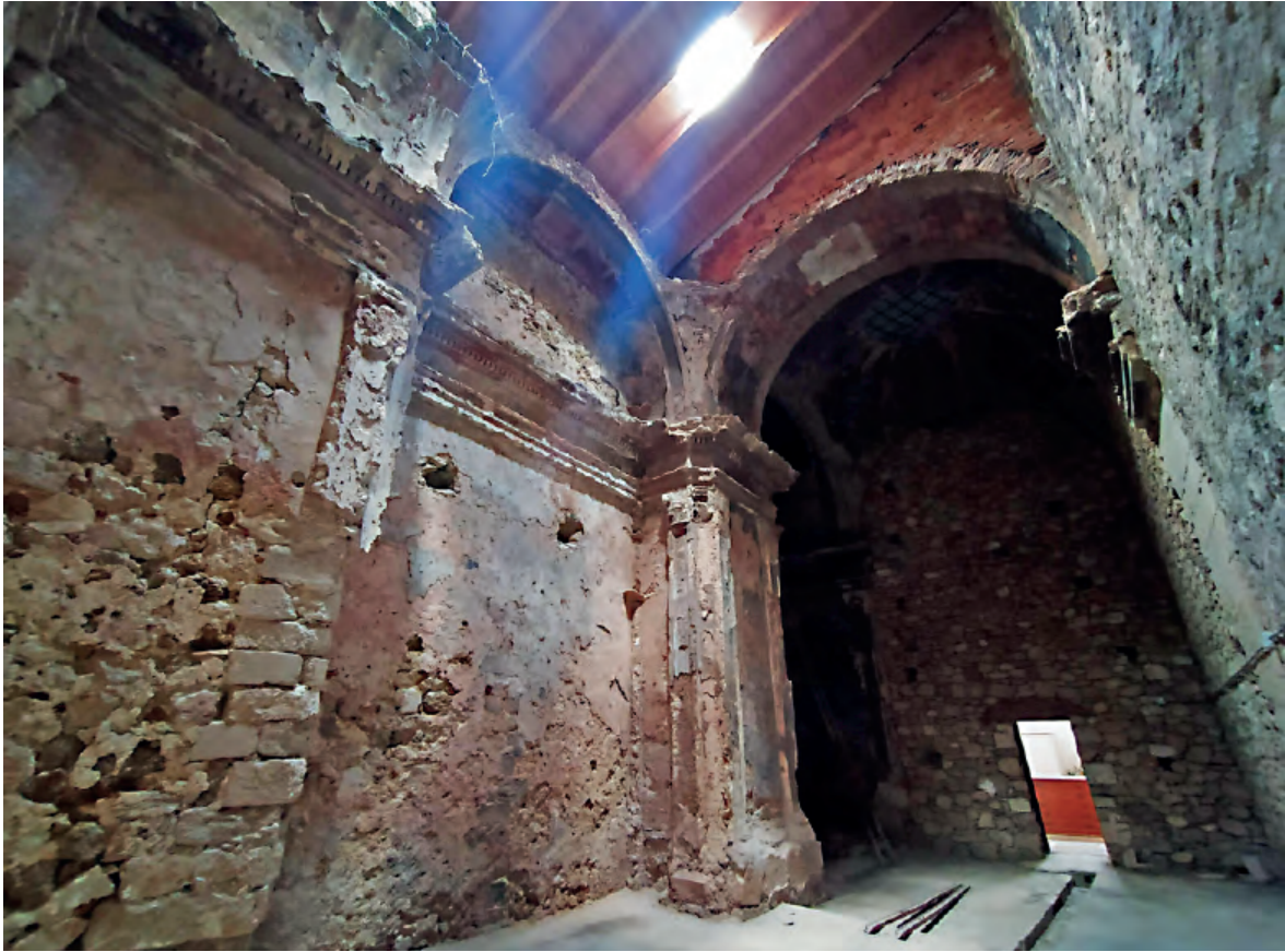
Fig. 128. Castellote (Teruel). Iglesia de San Miguel. Capilla de la comunión. Interior. Foto: Jorge Martín Marco.
