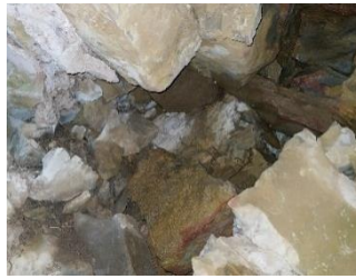
Ilustración 62. Detalle de las filtraciones de agua en el interior del refugio, Alto del Buitre, La Puebla de Valverde [Foto: Ester Morón, 2024].
