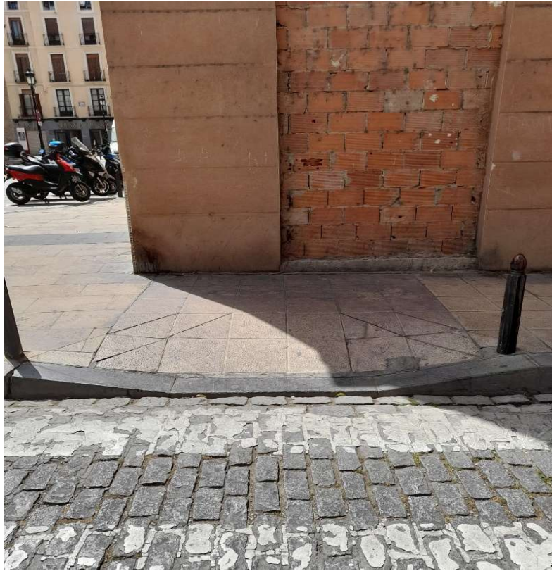
Imagen 9. Calle San Blas. Ejemplo de paso mal rebajado. Fuente: imagen propia
