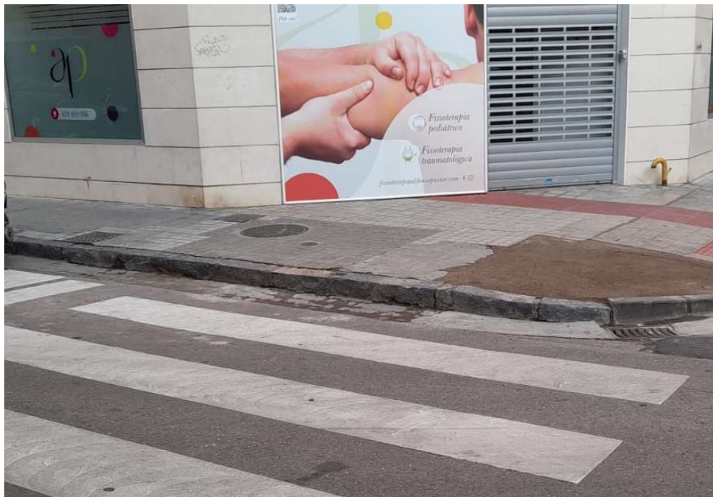
Imagen 4. Paso de peatones con bordillo sin rebajar (SR) . Fuente: elaboración propia
