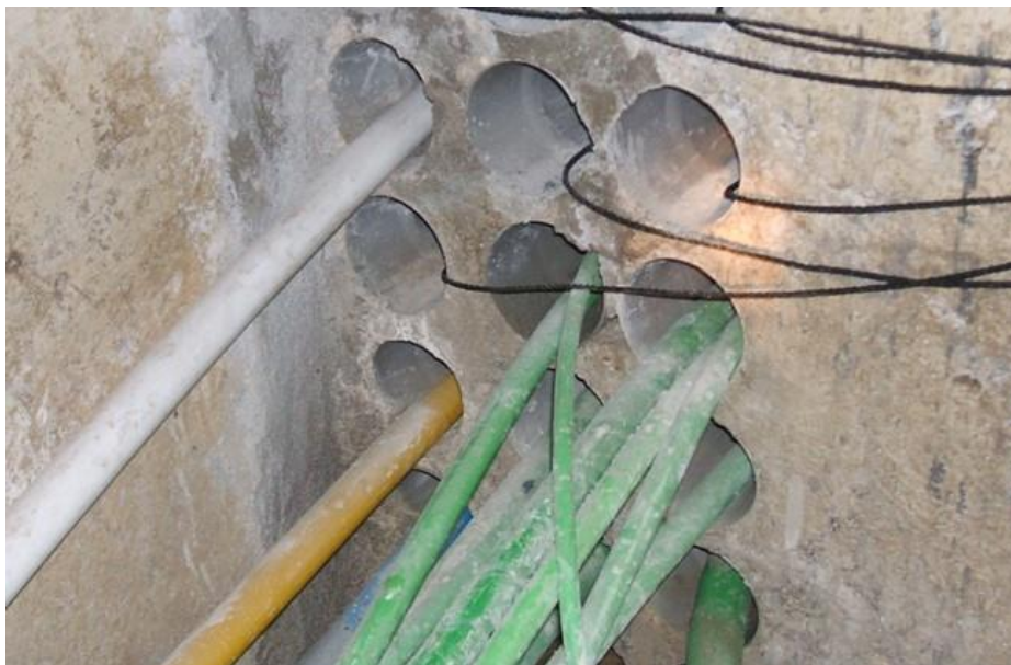
Ilustración 19: Prisma de tubos en arqueta de paso bajo vía. Fuente propia.
