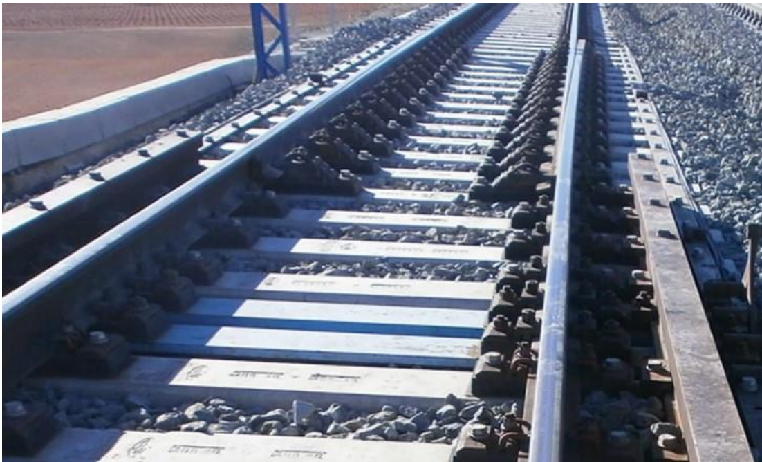
Ilustración 66: Aparato de dilatación en la LAV Madrid-Levante. Fuente propia.
