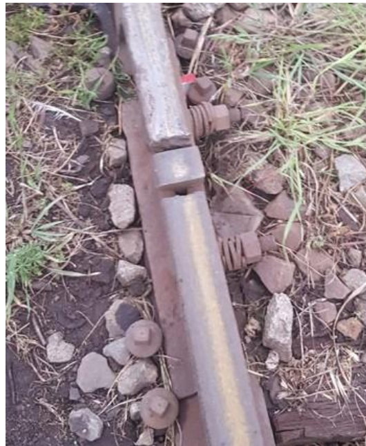
Ilustración 57: Cupón de carril RN45 en una cala para reducir el hueco y el golpeteo al pasar las ruedas del tren. Fuente propia.
