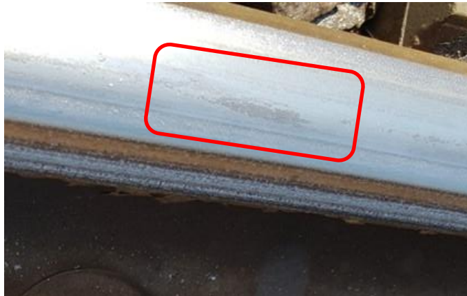
Ilustración 47: Patinazo en la banda de rodadura. Fuente propia.
