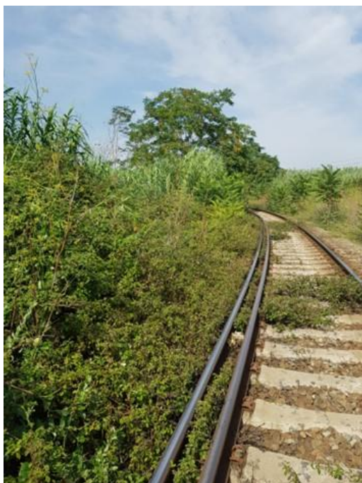
Ilustración 1: Plataforma afectada por la vegetación. Fuente propia.
