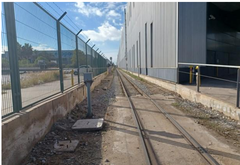
Ilustración 15: Plataforma sin drenaje longitudinal encajada entre edificaciones. Fuente propia.
