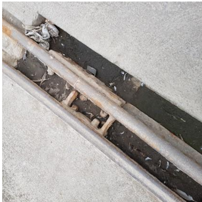
Ilustración 18: Acanaladuras de un desvío embebido en hormigón una vez drenado, con restos de suciedad y oxidado. Fuente propia.
