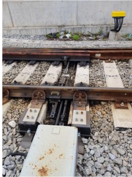
Ilustración 69: Accionamiento motorizado en el puerto de Barcelona. Fuente propia.
