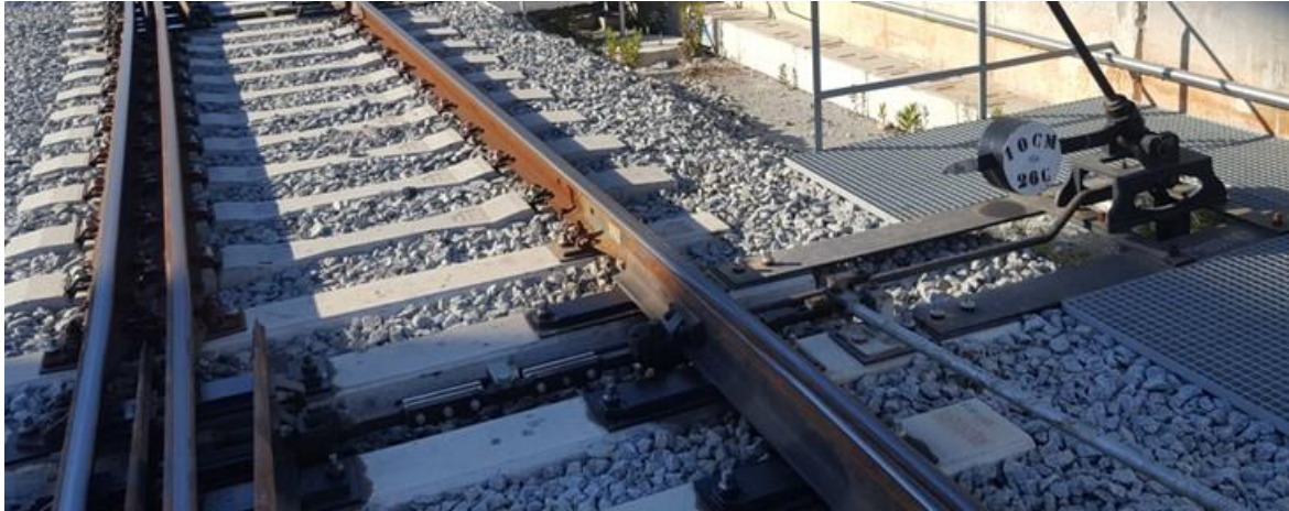
Ilustración 68: Desvío accionado mediante cerrojo de uña y marmita en el puerto de Barcelona. Fuente propia.
