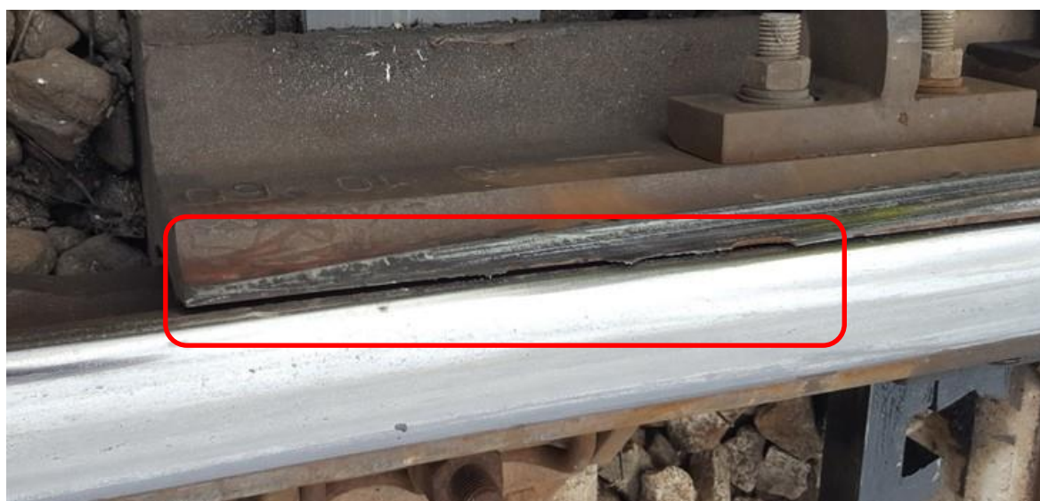
Ilustración 73: Punta de espadín deteriorada por desgaste. Fuente propia.
