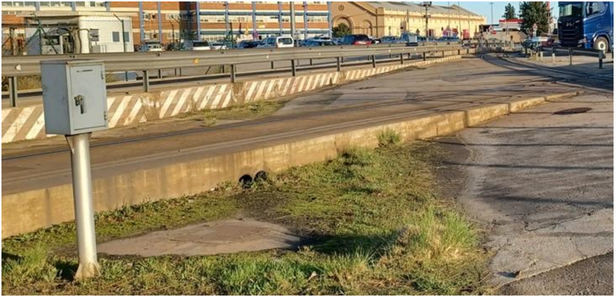
Ilustración 16: Drenaje transversal en plataforma de vía en placa. Fuente propia.
