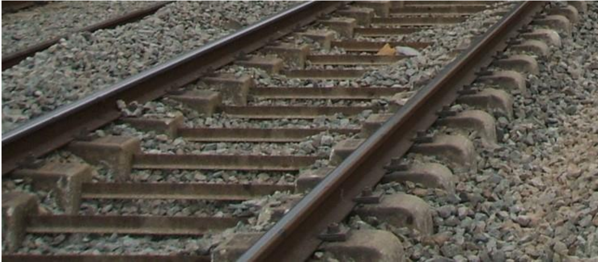
Ilustración 31: Traviesas RS con sujeción elástica J-2 [29] en la red convencional de Adif en El Prat de Llobregat. Año 2007. Fuente propia.
