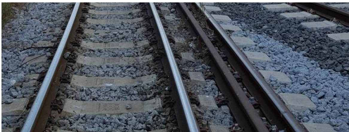
Ilustración 30: Traviesas de hormigón pretensado AM-05 para 4 hilos (3 anchos: ibérico internacional y métrico) con sujeción elástica en el Puerto de Barcelona. Fuente propia.
