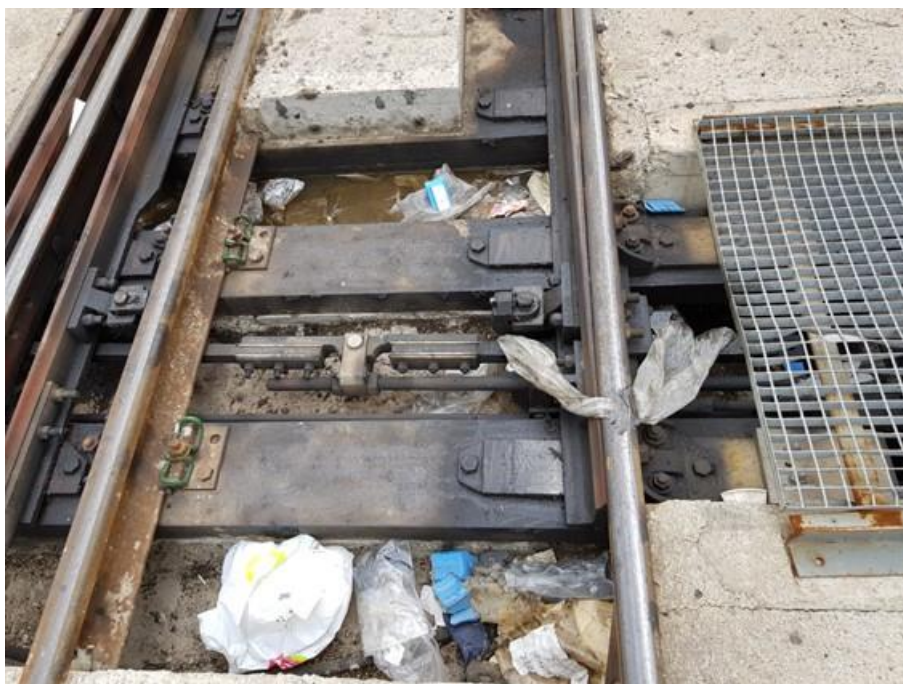
Ilustración 12: Acumulación de residuos en un desvío. Fuente propia.
