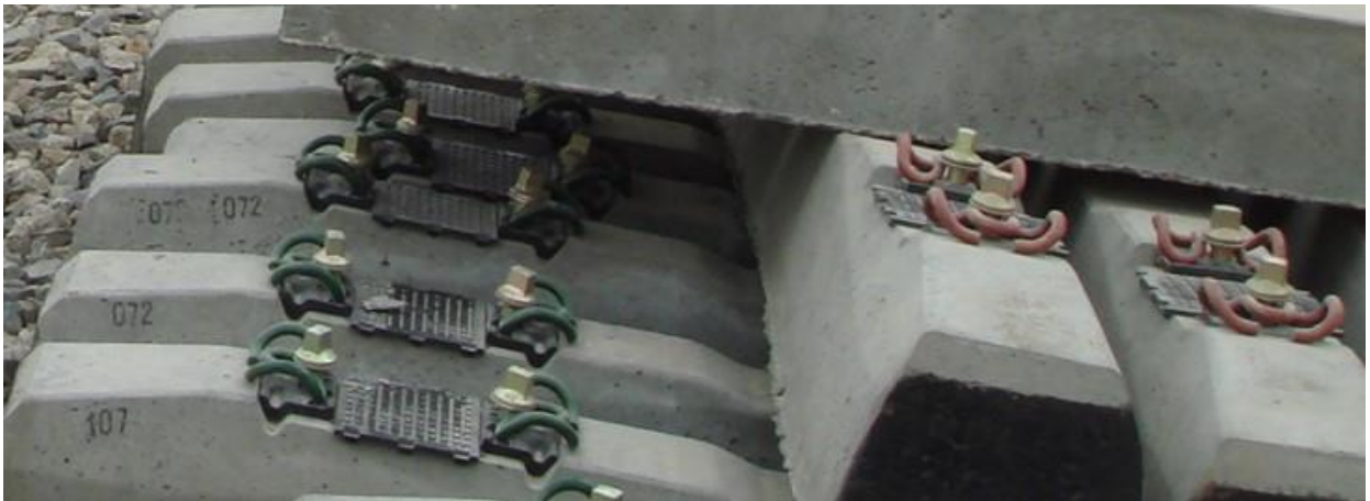
Ilustración 40: Placas de asiento elásticas y placas acodadas con clip SKL-1 sobre traviesa MR-00. L/Madrid-Zaragoza-Barcelona. Red convencional de Adif. Año 2007. Fuente propia.
