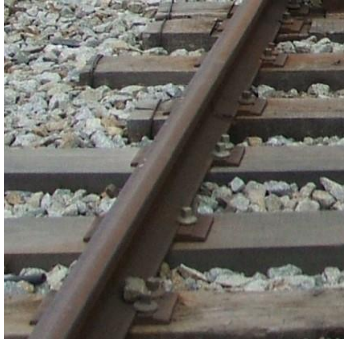
Ilustración 39: Placa de asiento metálica sobre traviesa de madera con tirafondo. L/Barcelona-Mataró, Red convencional de Adif. Año 2008. Fuente propia.
