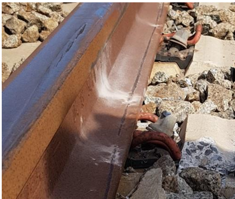
Ilustración 53: Marcas de arrastre de ruedas descarriladas en la cabeza y en el patín del carril y sujeciones rotas. Fuente propia.
