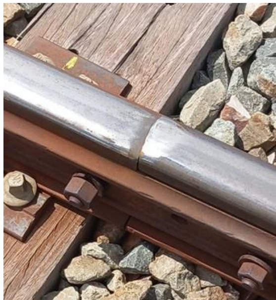
Ilustración 56: Junta de carril embridada y chafada por el paso de las circulaciones. Fuente propia.
