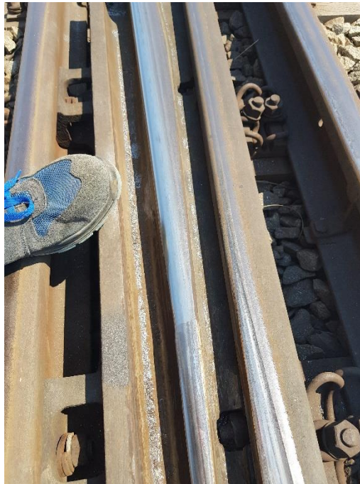
Ilustración 74: Virata metálica producida por desgaste por abrasión de las ruedas del tren en un cruzamiento. Fuente propia.
