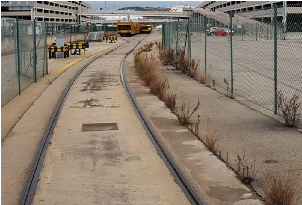
Ilustración 6: Herbáceas en juntas de hormigonado. Fuente propia
