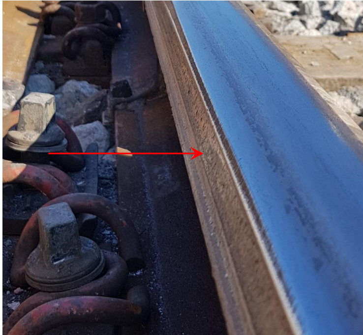
Ilustración 49: Cara activa de carril en curva desgastada por efecto de la deformación plástica. Fuente propia.
