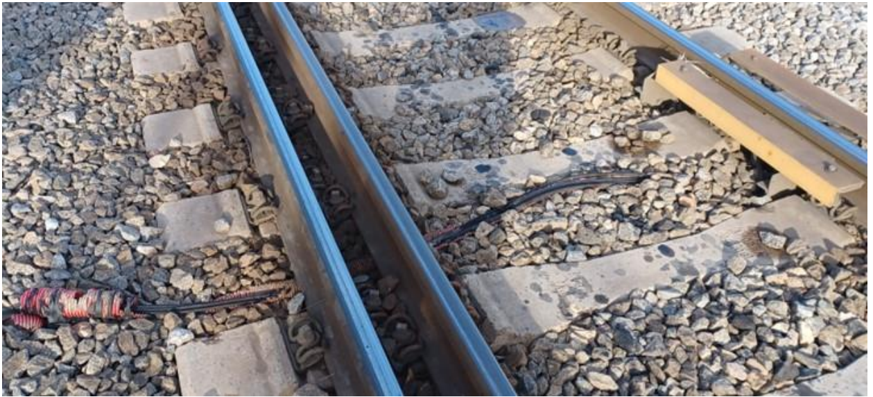
Ilustración 20: Cableado de conexión de un pedal cuyo corrugado de protección se ha degradado. Fuente propia.
