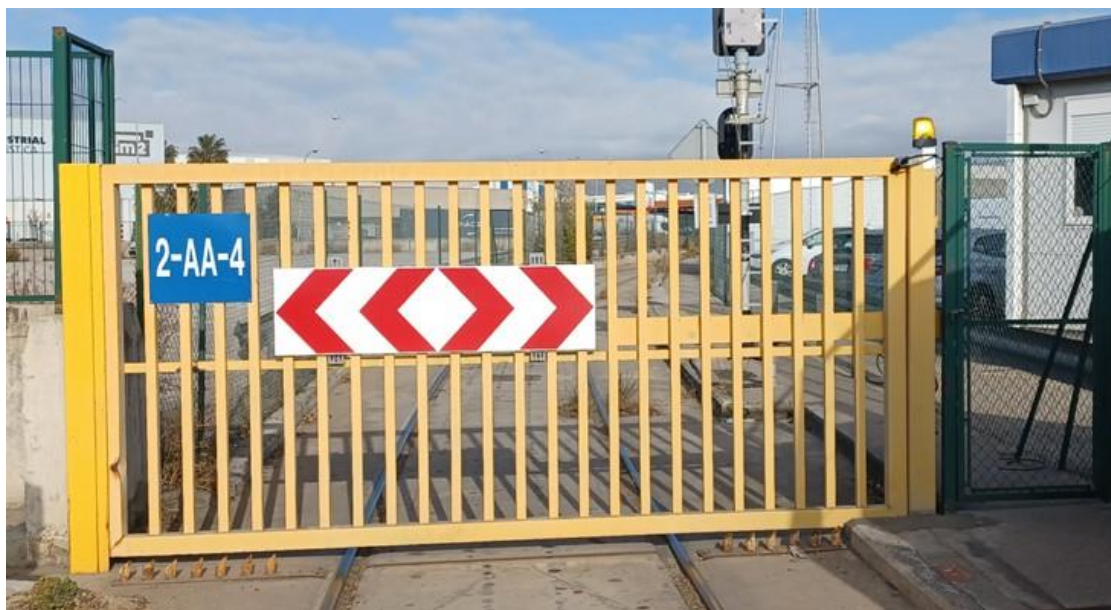
Ilustración 80: Puerta ferroviaria automática batiente de acceso a una terminal en el Puerto de Barcelona. Fuente propia.
