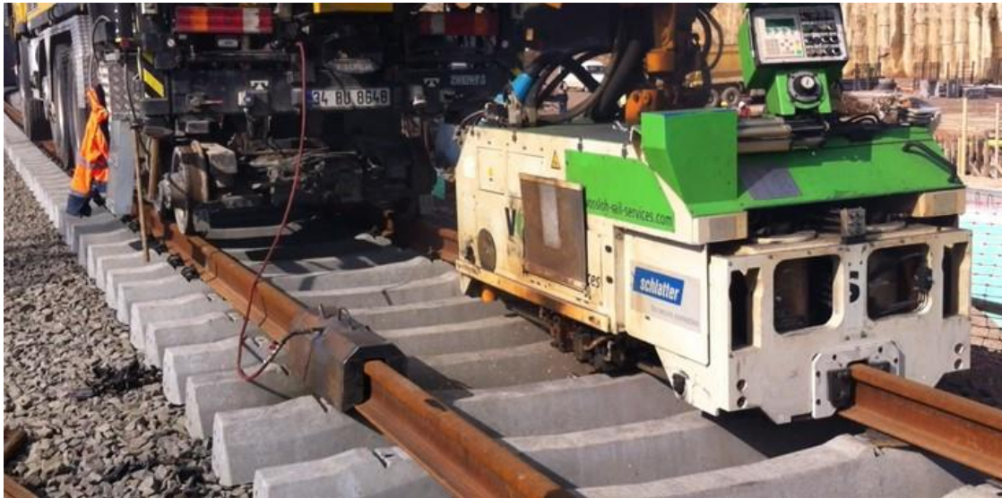
Ilustración 58: Camión de soldadura eléctrica a tope por chisporroteo. Proyecto Marmaray (Estambul) Feb-2014. Fuente propia.
