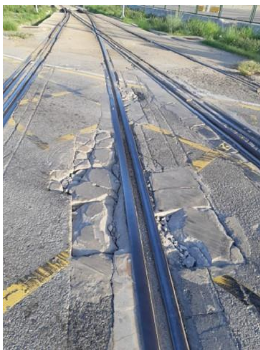
Ilustración 27: Pavimento cuarteado en una intersección especial en el Puerto de Barcelona. Fuente propia.
