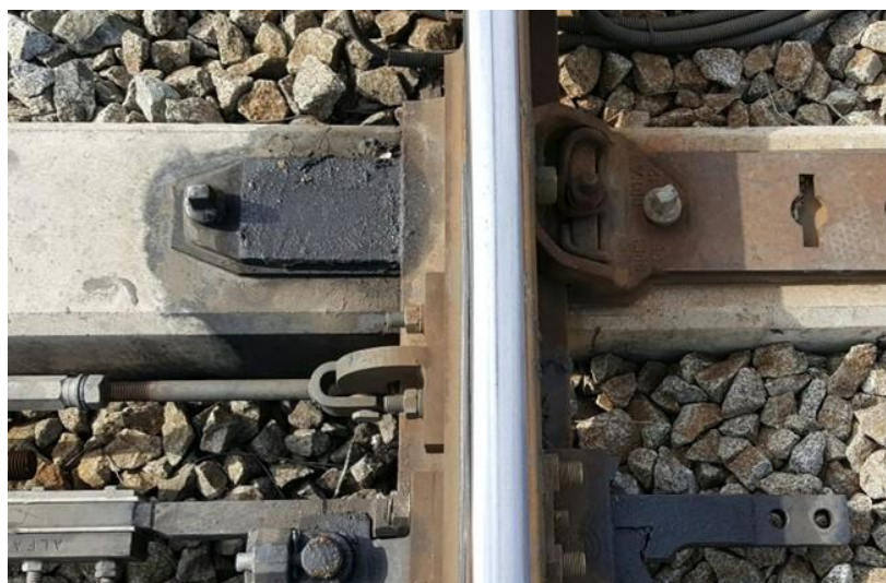
Ilustración 75: Resbaladera de una aguja de un desvío. Fuente propia.
