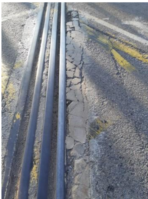
Ilustración 26: Pavimento cuarteado por el paso de vehículos en una intersección especial en el Puerto de Barcelona. Fuente propia.
