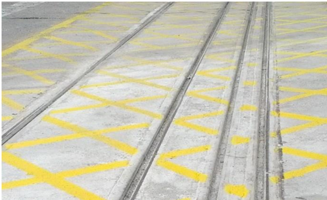
Ilustración 24: Intersección de vía en placa estuchada de anchos ibérico, UIC y métrico. Puerto de Barcelona. Fuente propia.
