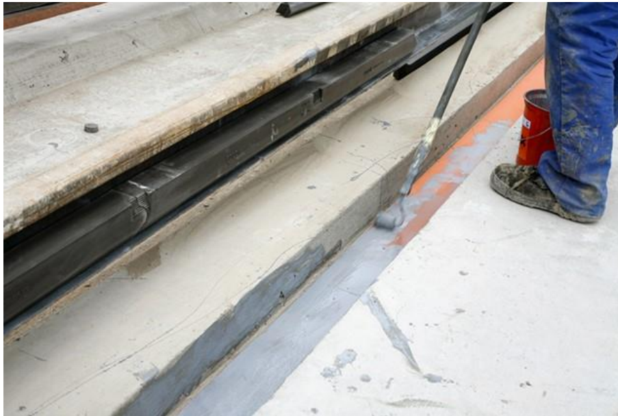
Ilustración 44: Instalación de banda de asiento, imprimación y tacos de elastómero en el alma de carril. Sistema Corkelast [34]. L.A.V. Madrid-Zaragoza-Barcelona. El Prat de Ll. Año 2007. Fuente propia.
