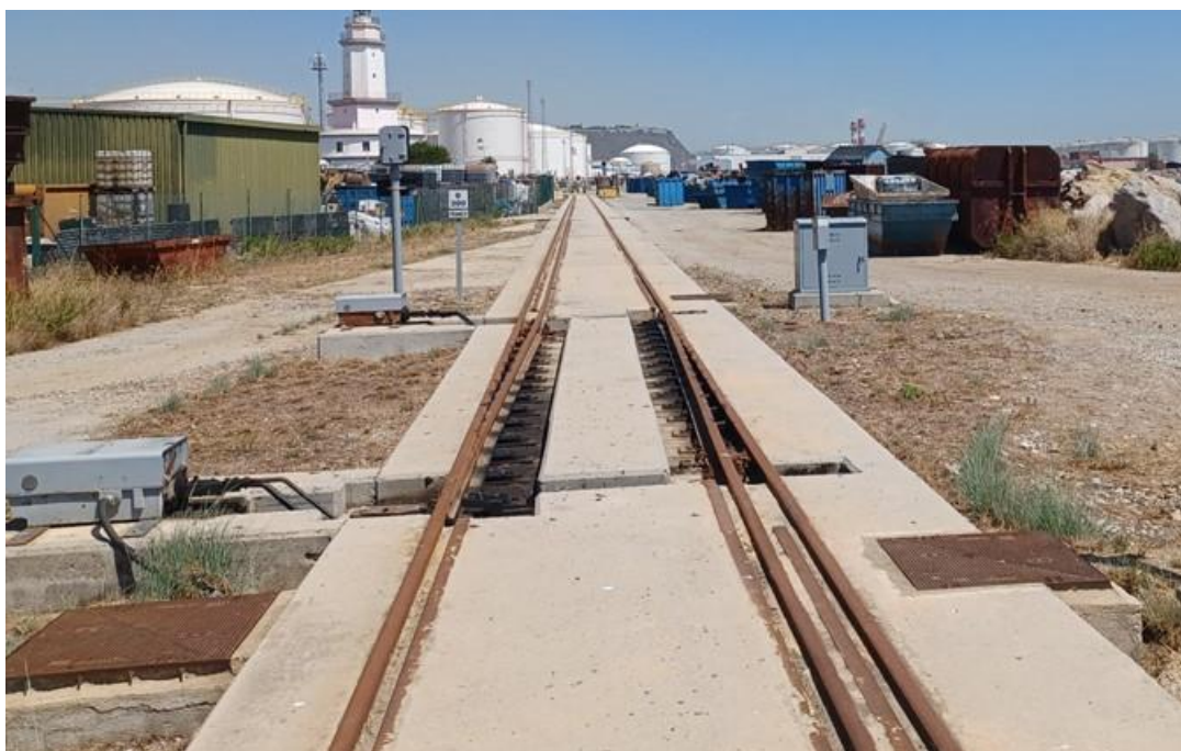
Ilustración 65: Cambiador de hilo para ancho UIC en el puerto de Barcelona.
