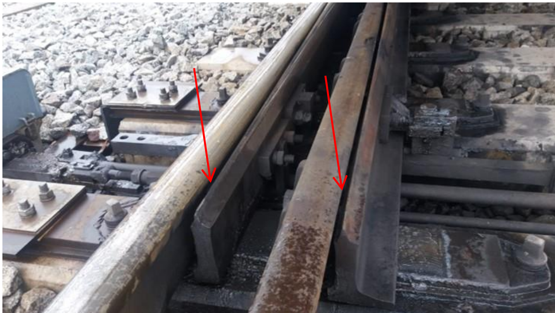
Ilustración 71: Espadines con acople incorrecto por daño en el cerrojo de uña o en el embrague del motor. Fuente propia.
