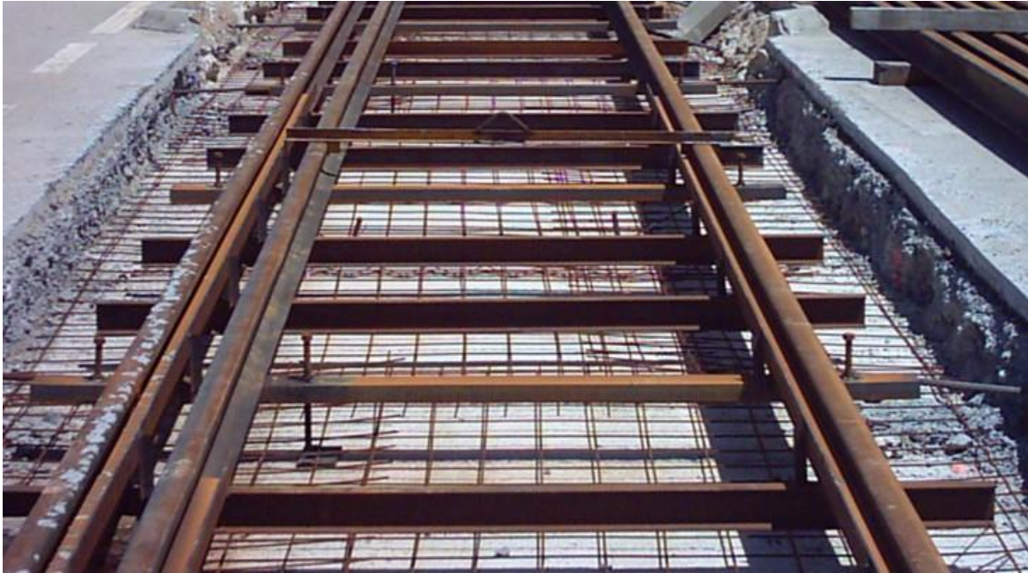
Ilustración 25: Vía en placa con perfiles a modo de traviesa en el Puerto de Barcelona. Fuente propia.
