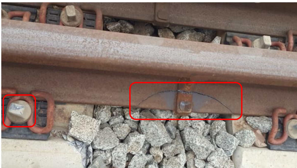
Ilustración 50: Patín partido en una soldadura por el paso de una rueda descarrilada de un vagón al apoyar en la pipa. Fuente propia.
