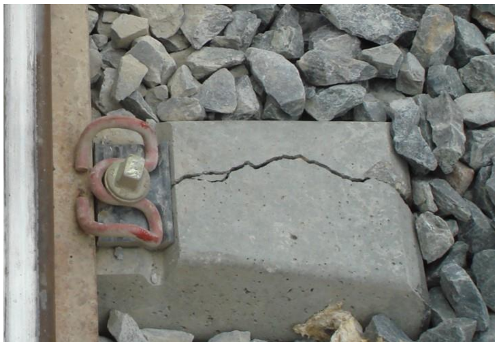
Ilustración 38: Traviesa monobloc rajada al reapretar tirafondo por acumulación de suciedad en la vaina. Fuente propia.
