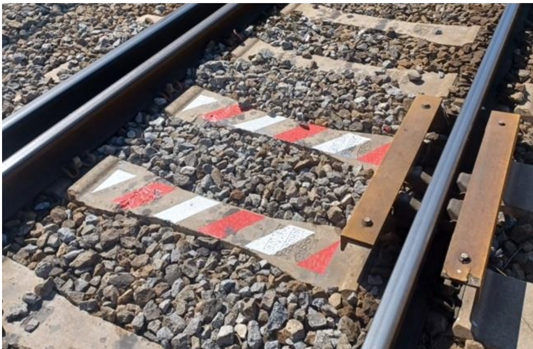
Ilustración 21: Paso de cableado señalizado para no dañarlo en caso de bateo. Fuente propia.
