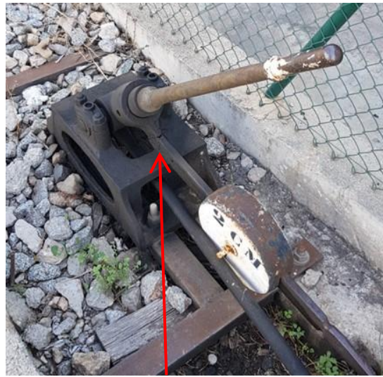
Ilustración 76: Barra de contrapeso parcialmente partida en un desvío con accionamiento con marmita. Fuente propia.
