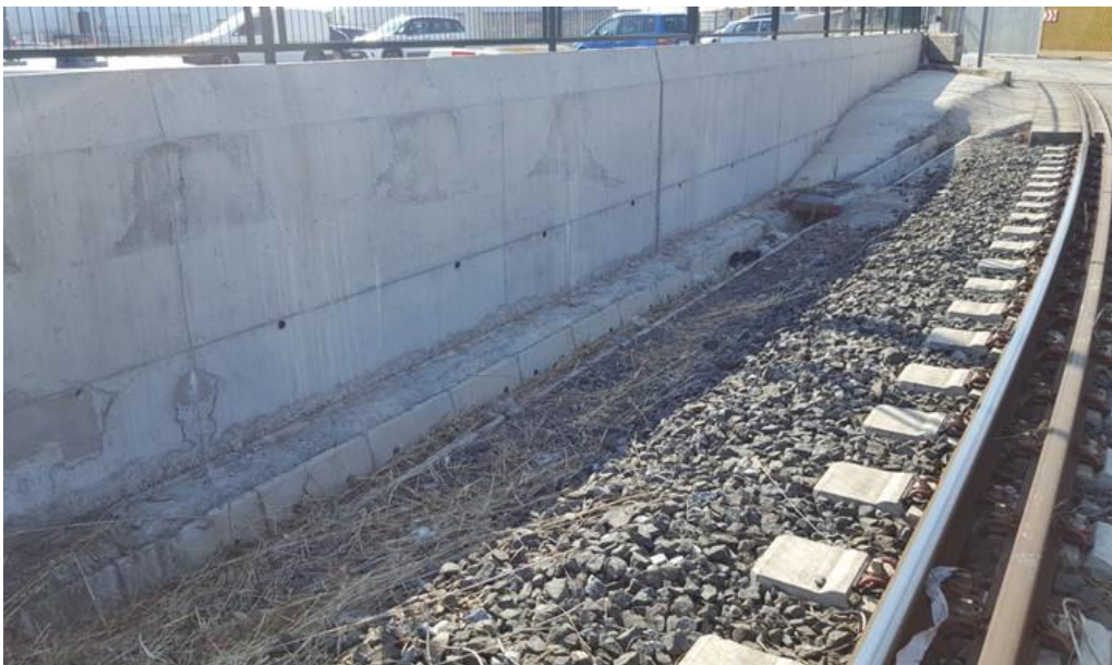
Ilustración 14: Drenaje longitudinal mediante cuneta hacia arqueta conectada a colector de vial de carretera. Fuente propia.
