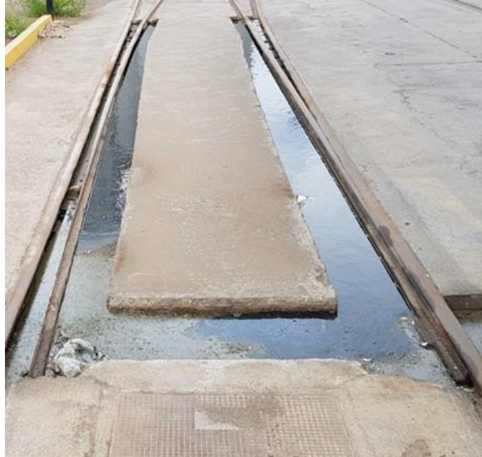
Ilustración 17: Desvío embebido en hormigón con el drenaje obturado. Fuente propia.
