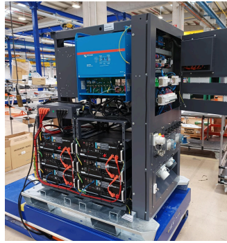
Figura 1. ZBP que muestra baterías e inversor
