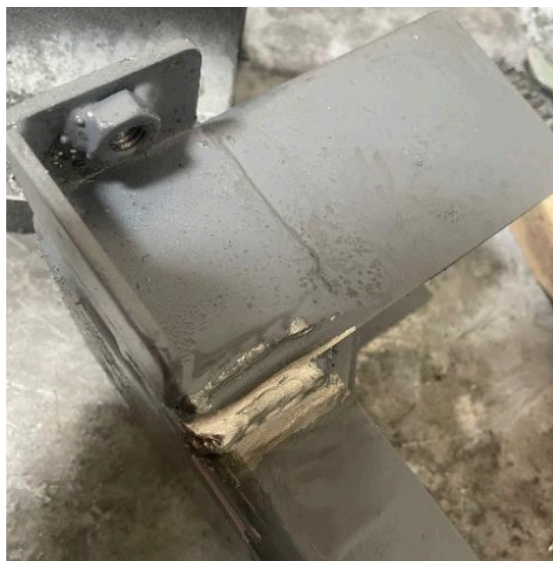
Figura 43. Cráter en el cordón de soldadura de la ZBP
