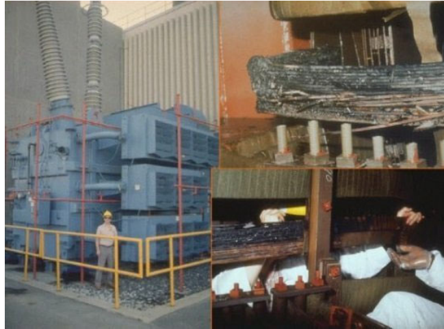
Figura 7: Transformador de la central de Salem dañado [ https://www.nuevatribuna.es/ ]
