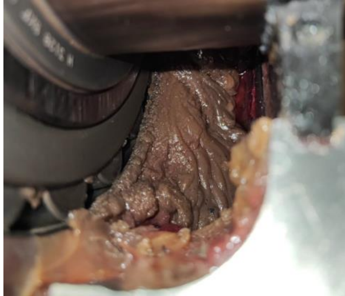
Figura 54: Muestra de virutas metálicas en la grasa del rodamiento NDE del Z1-VRI (Elaboración Propia, 2023)
