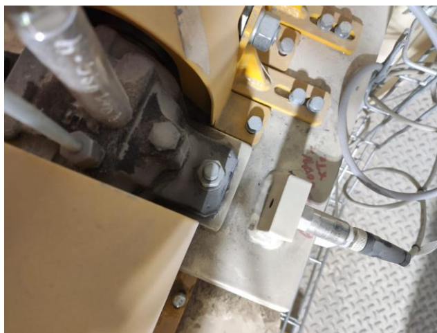
Figura 25: Sensores de vibraciones colocado incorrectamente (Elaboración Propia, 2023)
